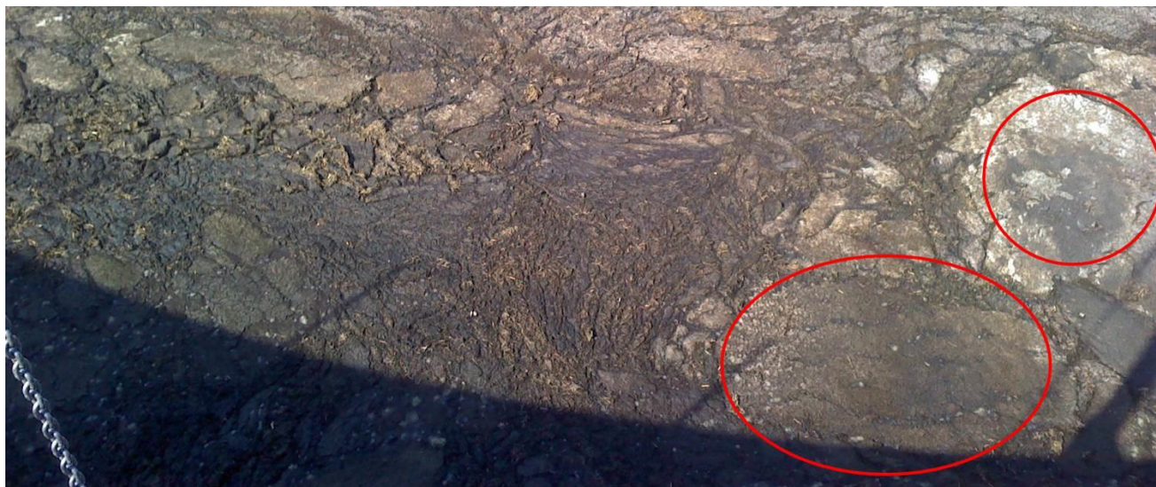
Abbildung 14: Beispiele für "geschlossene Schwimmschicht" rot markiert, Rest der Fläche ist entspricht der Kategorie "undicht! (Risse vorhanden)", Foto: Lippmann
