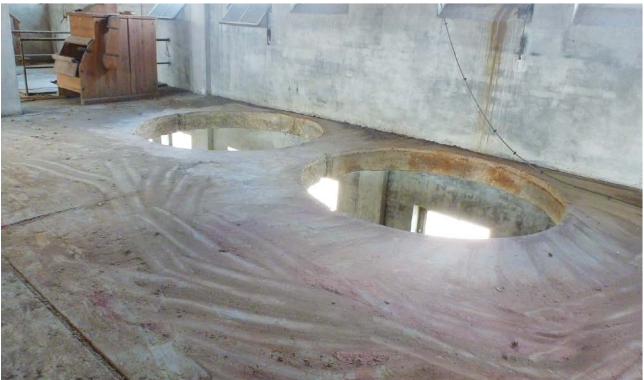
2.5.5 / Abbildung 1: kontaminierte Ablagerungen des Beizmittels (rosa) im Obergeschoss mit ungesicherten Deckendurchbrüchen
