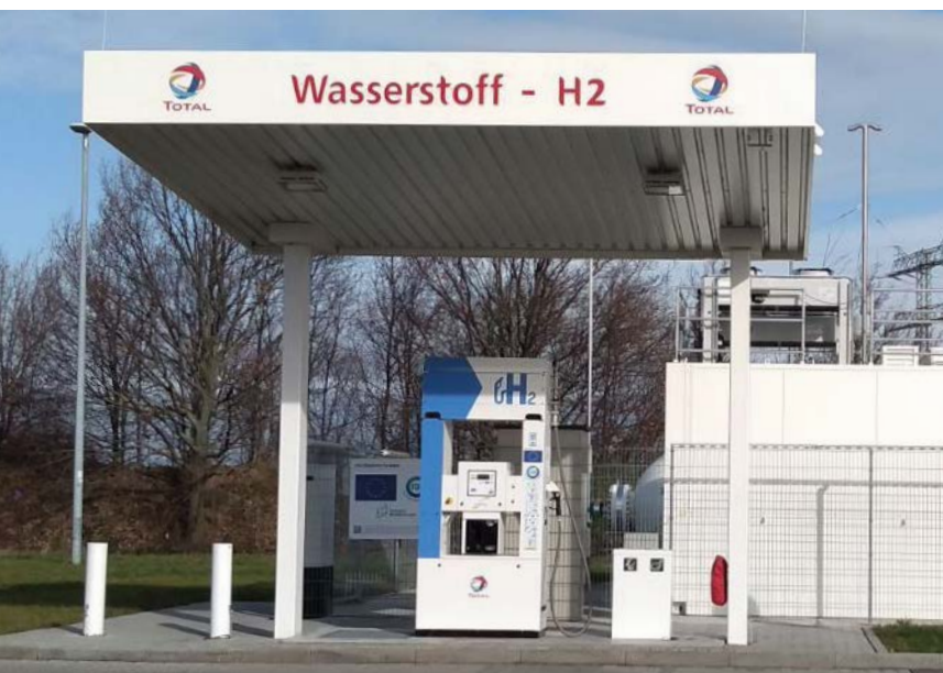
2.4.2 / Abbildung 2: Wasserstoffgasfüllanlage Leipzig Nord
