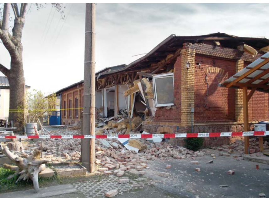
2.4.1 / Abbildung 1: Werkstattgebäude nach Explosion
