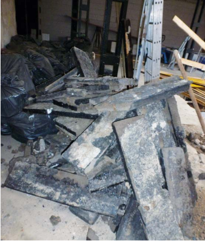
2.5.3 / Abbildung 2: abgebrochene, nicht verpackte teerhaltige Korkmaterialien
