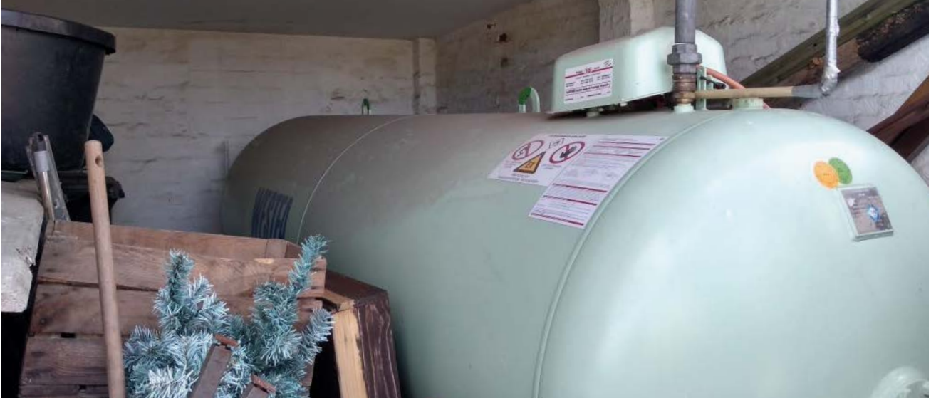
2.4.1 / Abbildung 2: Flüssiggaslagerbehälter mit Brandlast
