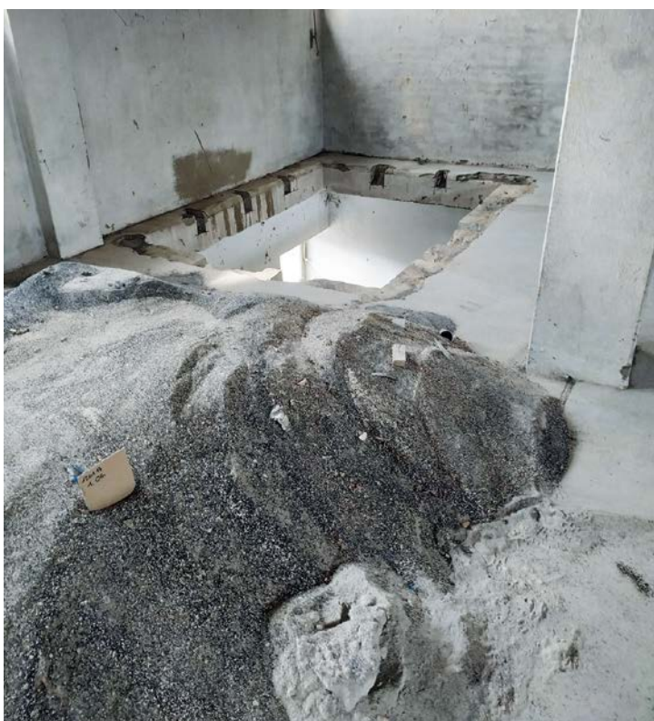
2.5.5 / Abbildung 2: ungesicherter Deckendurchbruch und kontaminierter Strahlschutthaufen
