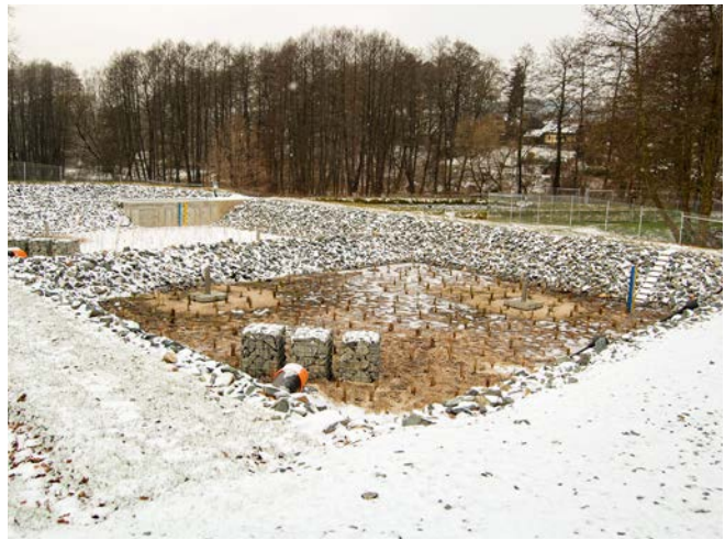
Pflanzenkläranlage Friesener Berg (Kapazität: 600 EW) Aufgabenträger: AZV Reichenbacher Land
