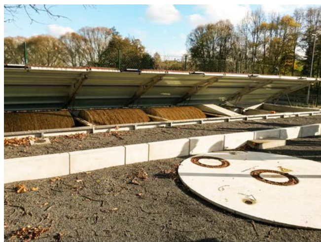
Kläranlage Lehndorf (Kapazität: 311 EW) und Ortsnetz, Aufgabenträger: AZV Am Klosterwasser
