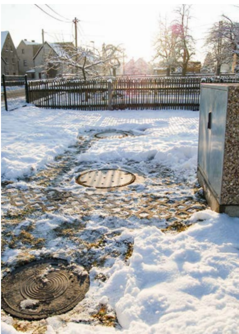
Öffentliche Gruppenkläranlage in Frohburg, Ortsteil Frauendorf (Kapazität: 50 EW) Aufgabenträger: Versorgungsverband Grimma-Geithain (VVG), Betriebsführer: Veolia Wasser Deutschland GmbH
