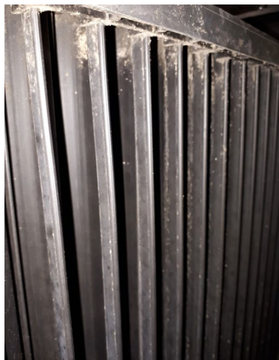
Abbildung 4: Biofilm und sichtbarer Schimmelbefall an einem Tropfenabscheider einer Kühlung
