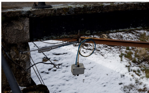
Abbildung 7-4: In-situ Installation des Dilatometers und Rissmessers mit Wärmeübertragungsfühler für die Messung der Materialausdehnung am Stausee Jezeří (über den Sperrhängen des Steinbruchs ČSA). Foto: VŠB – Technische Universität Ostrava.
