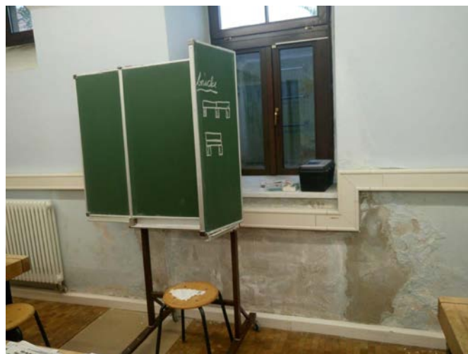
Abbildung 13: Feuchteschaden baulicher Ursache im Außenwandbereich eines Werkraumes
