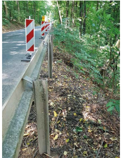
Abb. 17: Aufgestellte Warnbaken am Straßenrand der Hauptstraße zwischen Ebenheit und Struppen, nachdem die Straße in Folge des Starkregens unterspült wurde
