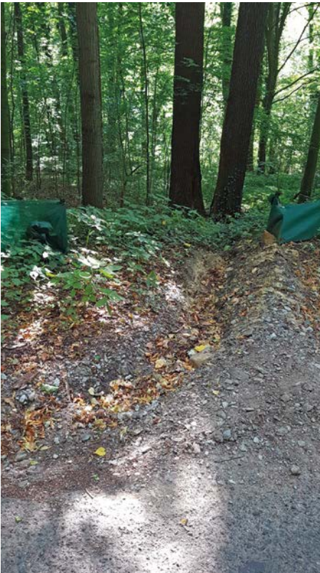
Abb. 16: Abflusrinne zur Ableitung des Regenwassers von der Ortsverbindungsstraße zwischen Struppen und Obervogelgesang in den Struppenbach
