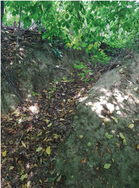
Abb. 21: Abflussrinne zur Ableitung des Oberflächenwassers von der angrenzenden Ackerfläche, welche rechtsseitig oberhalb des Struppengrundes gelegen ist
