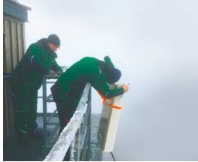
Abb. 3: Installation einer Ultrakurzwellen-Antenne auf dem Fichtelberg
