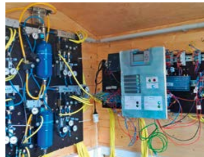
Abb. 9: Testweiser Betrieb eines intern entwickelten Prototyps in der BDF-II-Station Hilbersdorf
