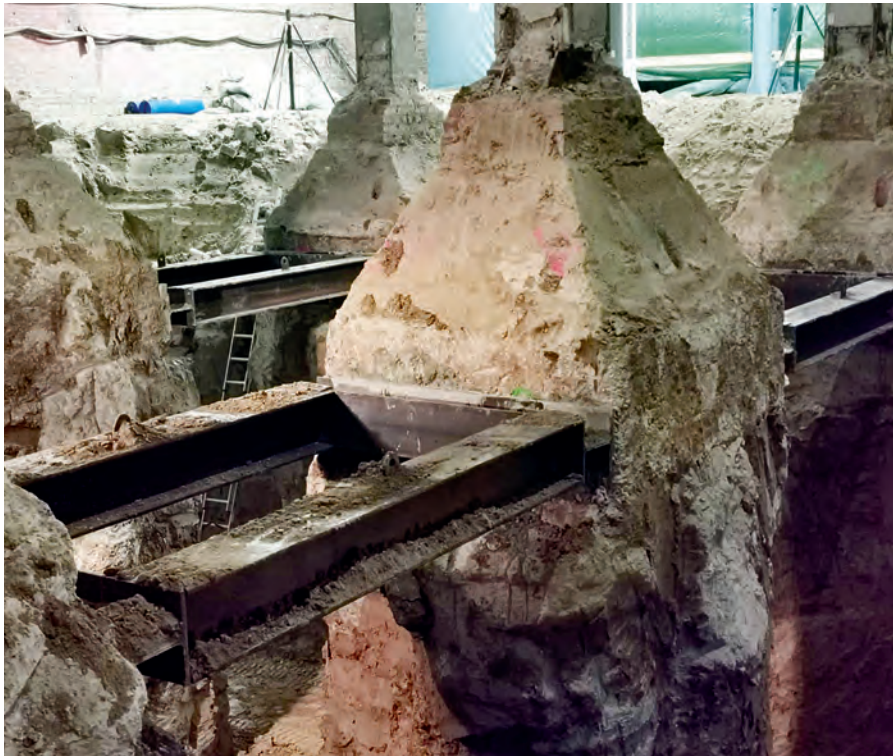
2.5.4 / Abb. 1: Freigelegtes und untergrabenes Fundament der ehemaligen Fabrikhalle mit Galvanik
