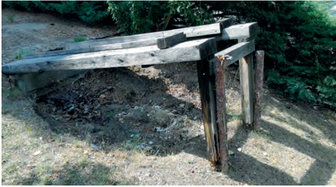
2.2.3 / Abb. 1: Auffahrrampe für Rasentraktoren mit morschen Stützen (wurde komplett entfernt)
