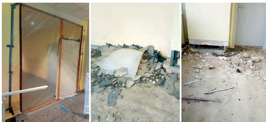
2.5.2 / Abb. 1 bis 3: Vorher: unsachgemäße PAK-Sanierung
