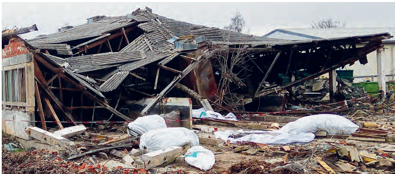
2.5.3 / Abb. 1: Einsturzgefährdete Hallenbereiche
