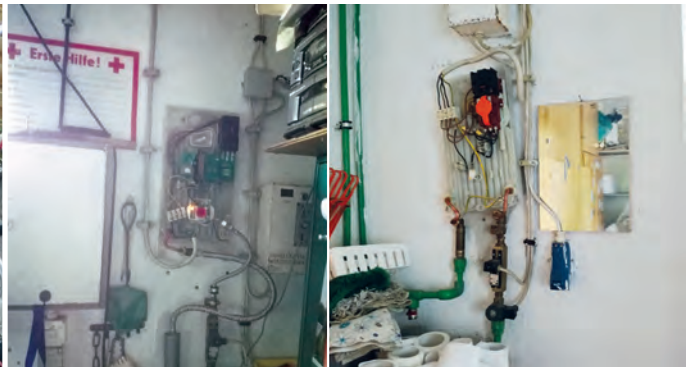
2.2.3 / Abb. 4: Durchgangserhitzer für Warmwasser ohne Schutzabdeckung mit freiliegenden aktiven Teilen der elektrischen Anlage neben der Werkbank im Hausmeisterbereich (wurde vor Ort sofort vom Stromnetz getrennt)
