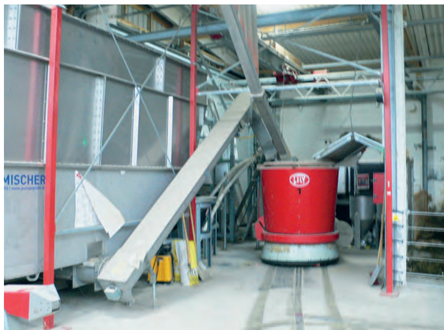
2.2.4 / Abb. 1: Übersicht Fütterungsanlage
