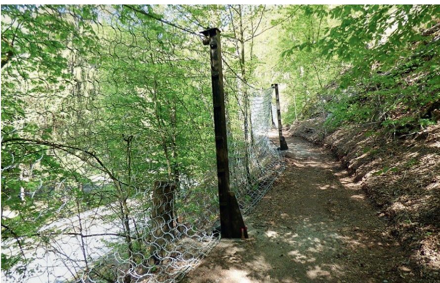
Abb. 2: Fangzaun Ostrauer Mühle – der temporäre Fangzaun ist der einzige im Nationalpark, der zum Schutz vor herabstürzenden Bäumen aufgebaut werden musste. Er befindet sich unmittelbar oberhalb der Kirnitzschalstraße gegenüber dem Zeltplatz. Foto: Helen Rößler
