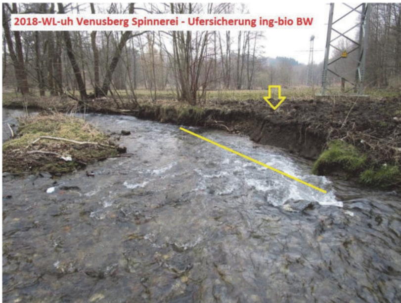
Abbildung 20: Gefährdeter Flussabschnitt der Wilisch vor der Ufersicherung
