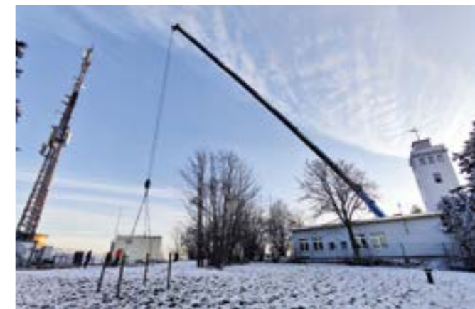
Abb. 3: Aufbau eines zweiten Luftmesscontainers auf der Messwiese in Radebeul-Wahnsdorf
