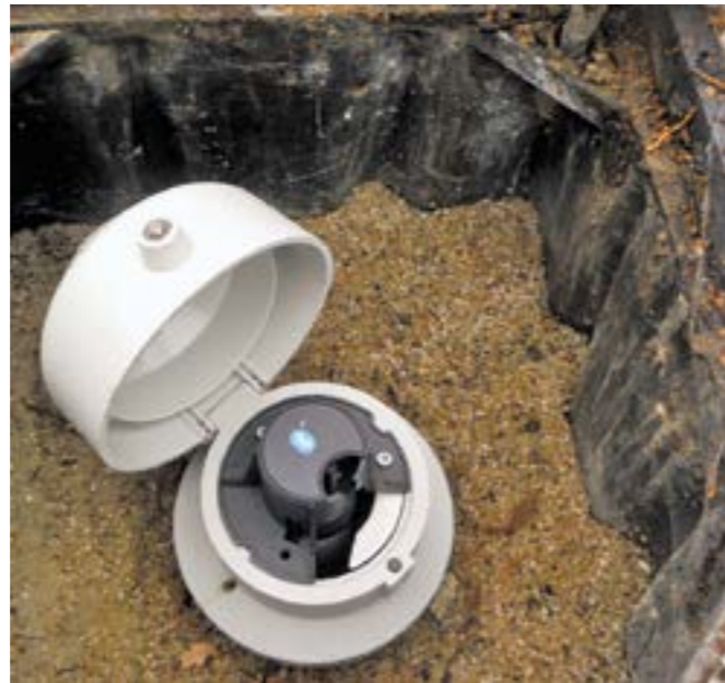
Abb. 4: Ausrüstung Unterflurmessstelle Burgstädt mit Datenfernübertragung
