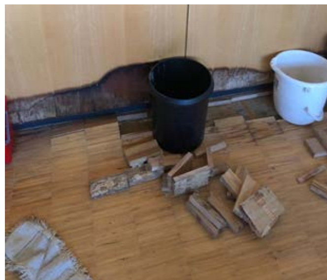
Abbildung 15: Feuchteschaden im Wandbereich einer Berufsschule
