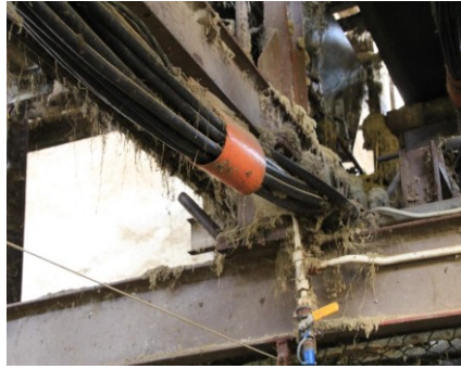
Abbildung 24: Verschmutzte Decken und Kabel in der Futterküche
