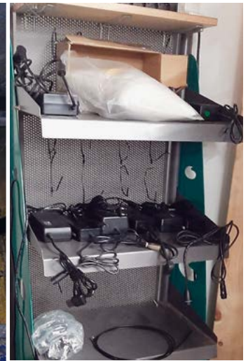
2.2.1 / Abb. 5: Laderegal für Batterien
