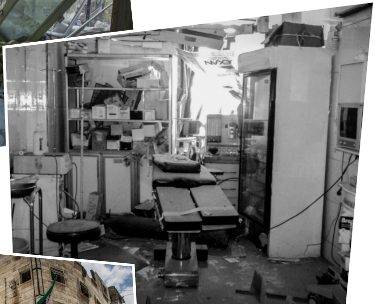
Bild 5: Schwere Beschädigung des al-Bayan Krankenhauses im Juli 2016
