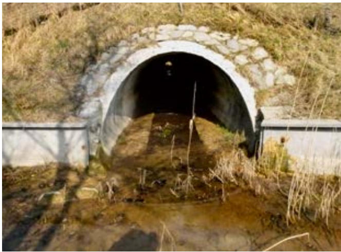
Abb. 34: Durchlass (< 2 m) – Amphibientunnel – mit temporärem Gewässer an der A40st
