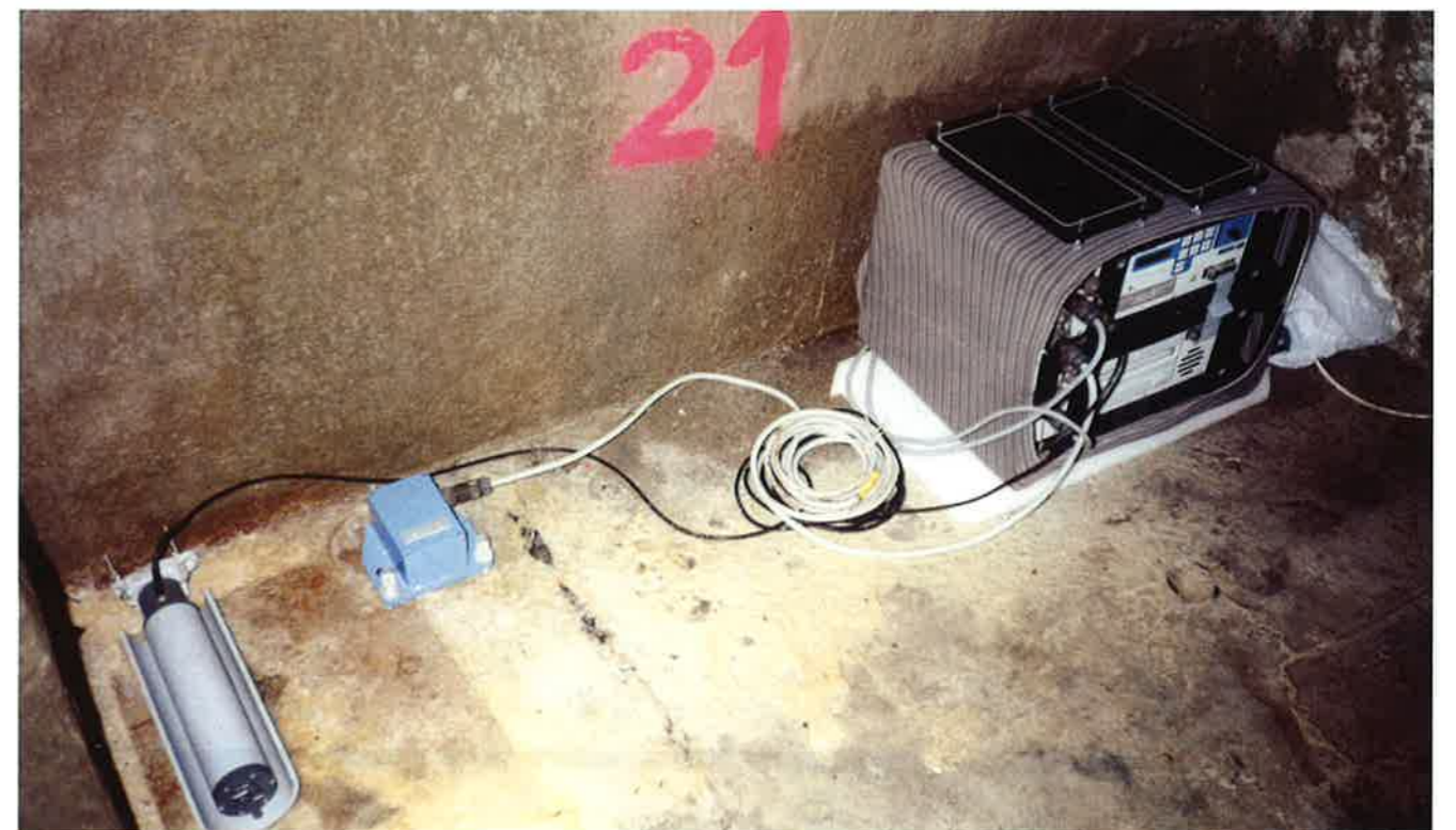
Abb. 3: Mobile Station „MARS88“ in der Talsperrenstaumauer Muldenberg (Antenne für Zeitsignal, Seismometer, Registrierapparatur)
