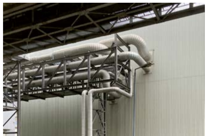
Anschluss der Übergabestation an die Leitungsinfrastruktur
