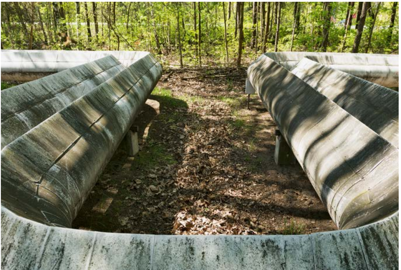
Isolierte Fernwärmeleitung mit Dehnungsausgleich
