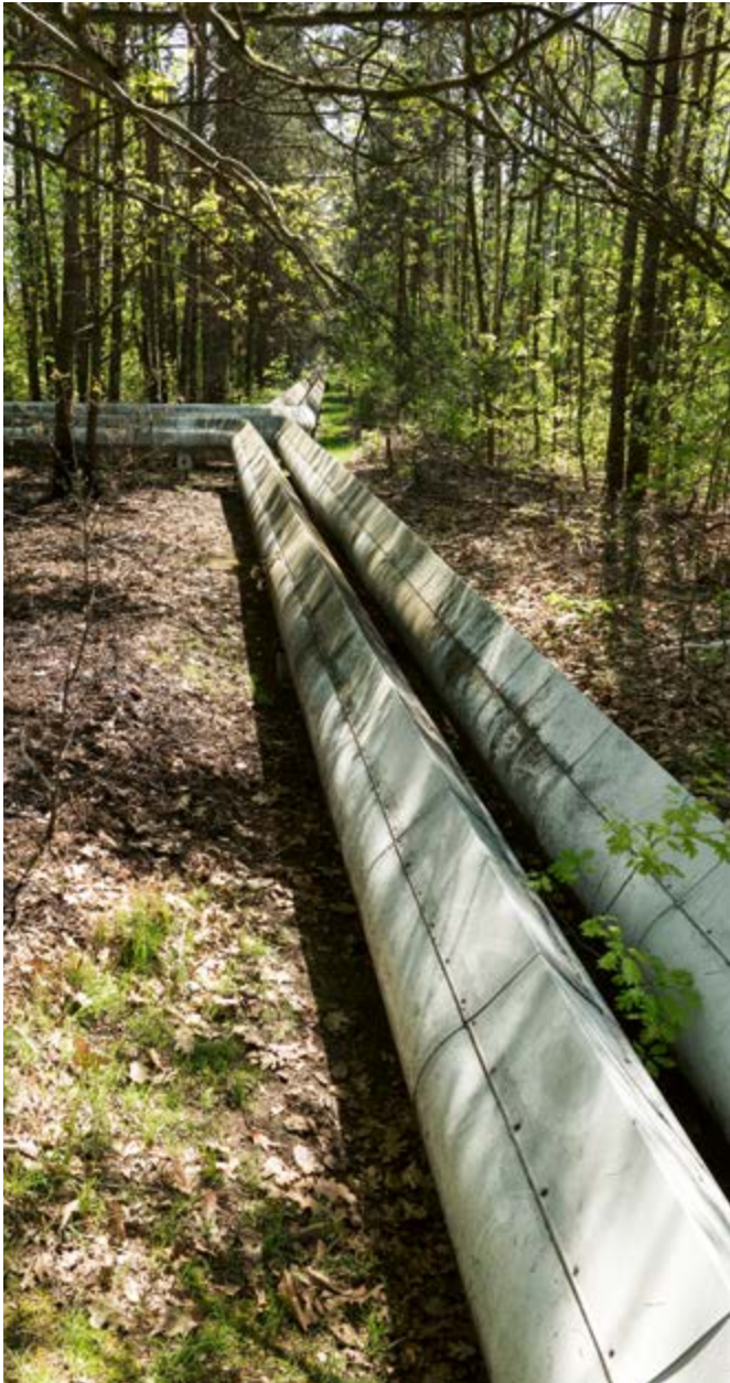
Isolierte Fernwärmeleitung mit Vor- und Rücklauf nahe Weißwasser/O.L.
