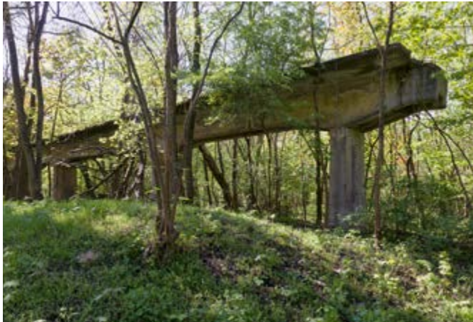
Rest der Gleisbrücke
