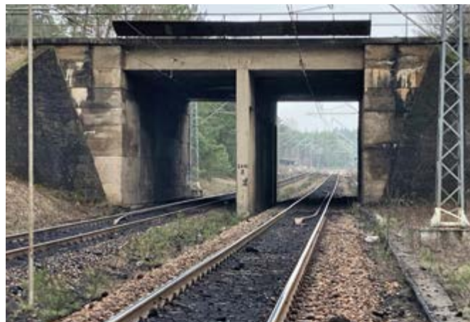
Brücke des ehemaligen »Kleinen Kohlerings« über die heutige LEAG-Werkbahn Boxberg-Schwarze Pumpe nahe Spreewitz
