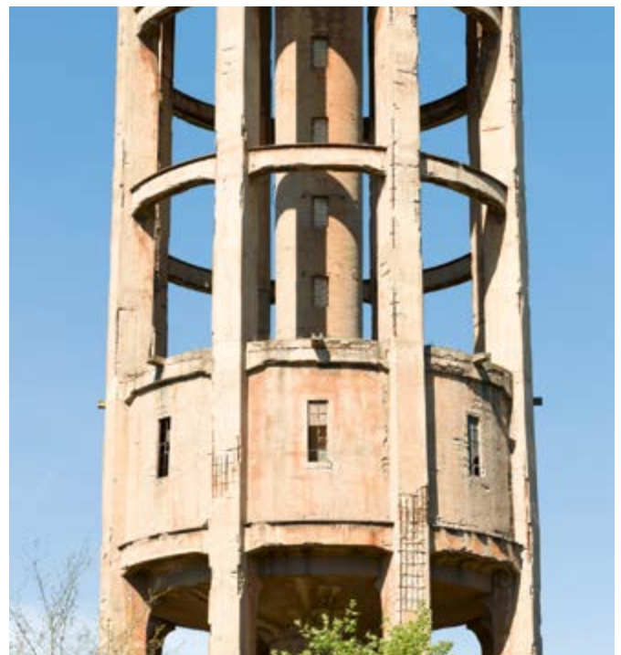
Unterer Behälter für Betriebswasser
