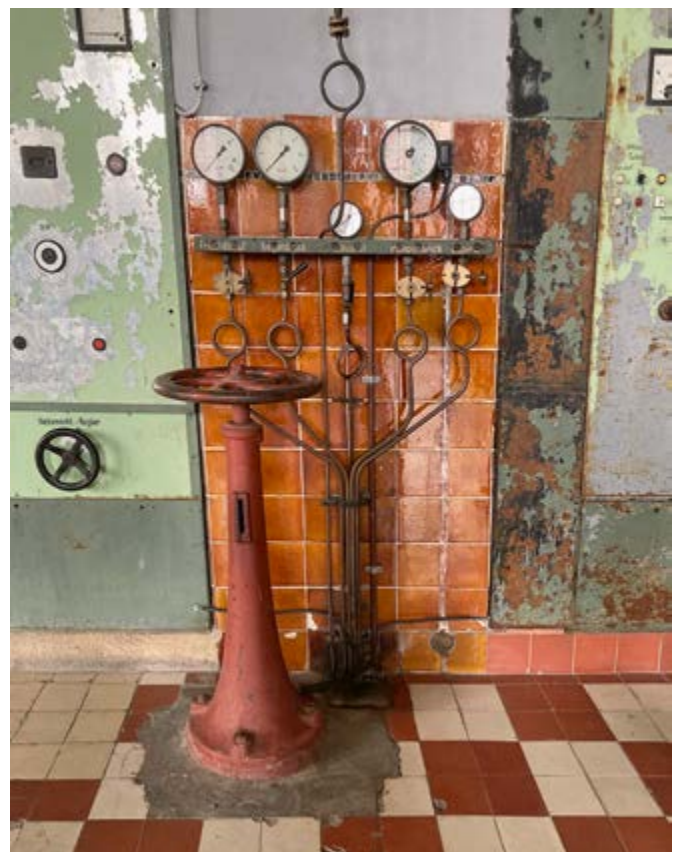
Anlage zur Druckmessung
