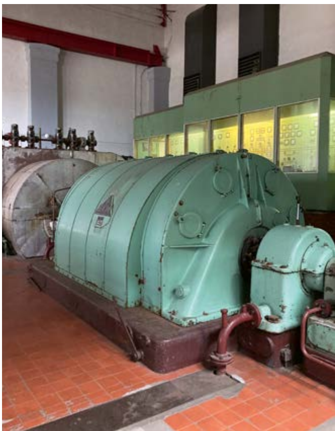
Turbinensatz mit Schaltwarte im Hintergrund
