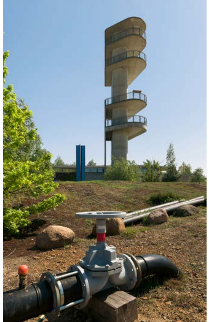
Absperrschieber einer Entwässerungsleitung, im Hintergrund der Aussichtsturm
