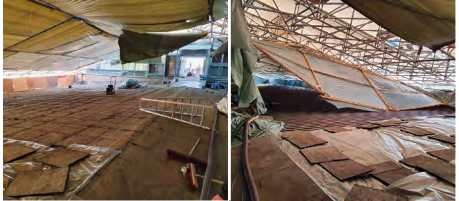
2.4.1 / Abb. 3 und 4: Sturmschäden
