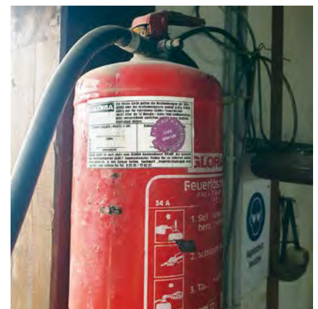
2.1.1 / Abb. 2: Vorgefundener Feuerlöscher im Werkstattbereich
