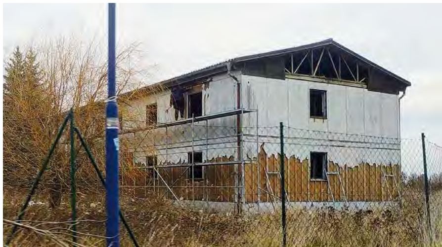
2.4.5 / Abb. 3: Fortsetzung unsachgemäßer Abbruch asbesthaltiger Fassade
