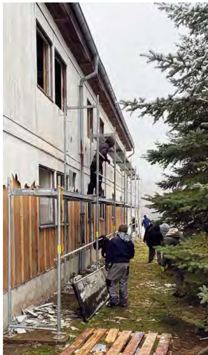
2.4.5 / Abb. 1: Fehlende Schutzmaßnahmen bei Arbeiten mit asbesthaltigen Materialien
