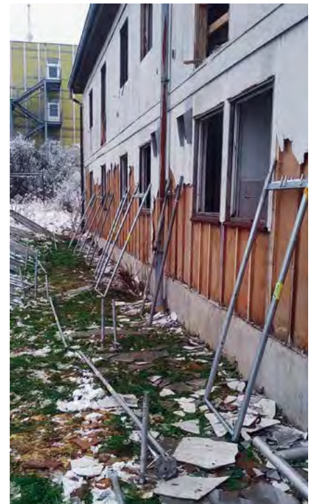
2.4.5 / Abb. 2: Gebrochene asbesthaltige Fassadenplatten
