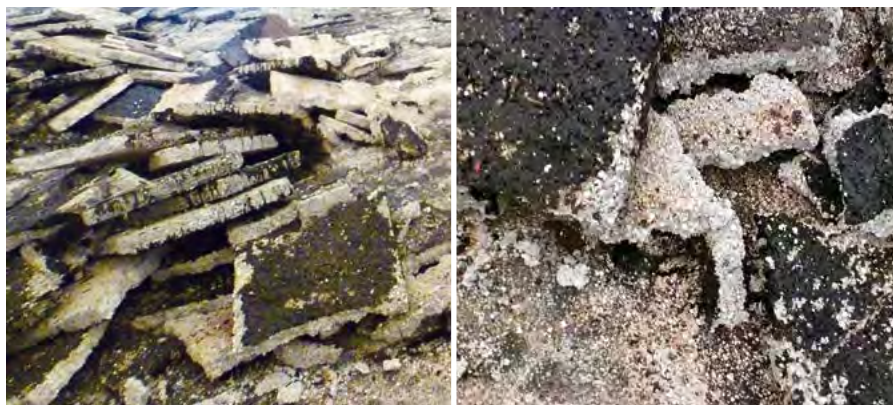
2.4.1 / Abb. 1 und 2: Rapoly®-Dämmplatten und Zerfall bei mechanischer Einwirkung
