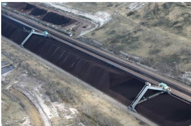
Kohlemisch- und Stapelplatz mit Portalkranern im Abbaufeld Peres
