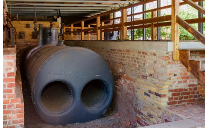
Kesselhaus mit technischen Anlagen, Blick von Osten
