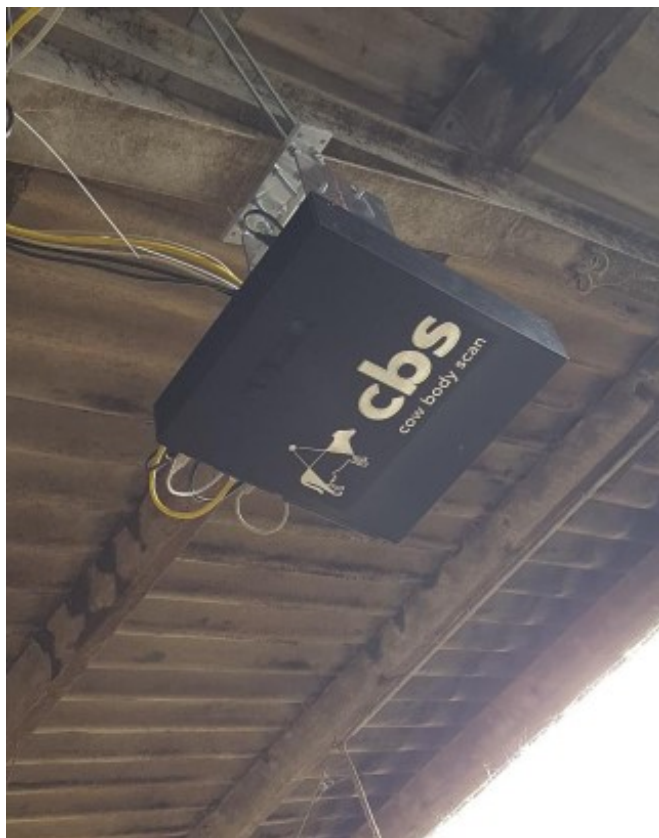
Abbildung 4: Installierter CBS-Sensor über dem Laufgang
