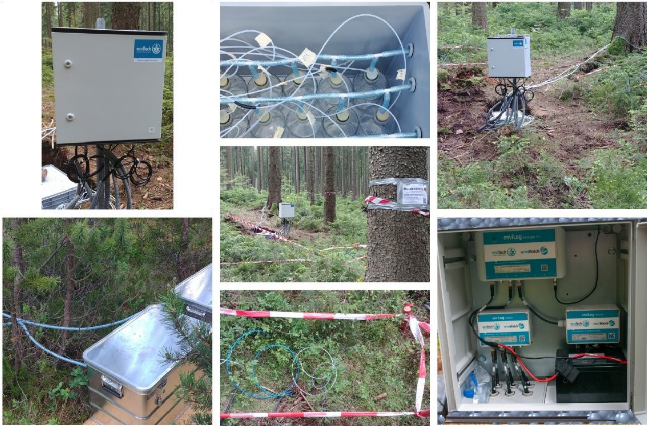
Abbildung 15: Exemplarisches Beispiel eines Bodenmessplatzes an der Talsperre Sosa, nach erfolgreicher Installation mit Steuerungseinheiten für Tensiometer bzw. Bodenfeuchtesensoren, Steuerungseinheit und Sammelgefäße für die Saugkerzen und Saugplatten
