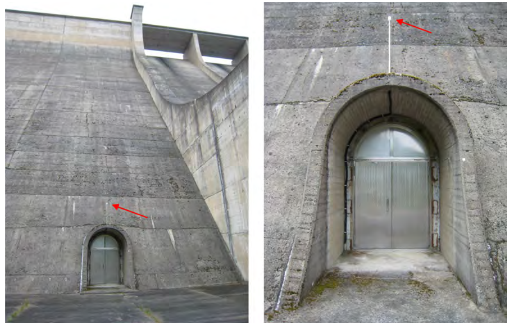
Abb. 3.1-4: GPS-Antenne der Online-Station EIBE im Außenbereich der Talsperre Eibenstock.
