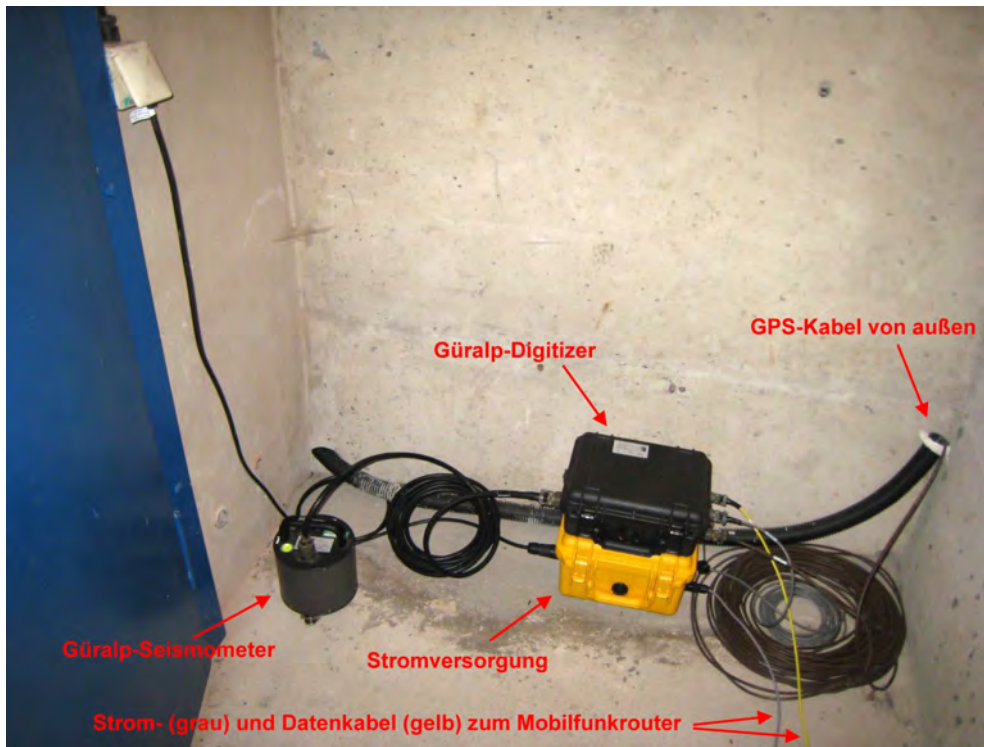
Abb. 3.1-5: Online-Station EIBE in kleiner Kammer am südlichen Mauerfuß.
