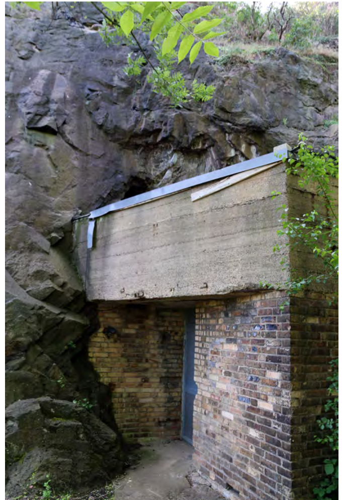
Abb. 3.2-1: Verwinkelter Eingang zur Bunkeranlage am Kapellenberg in Landsberg. Die Gänge erstrecken sich rund 20 m weit in den Felsen hinein.
