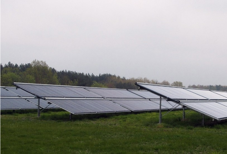
Abbildung 2: Solarthermieanlage für die Fernwärmeversorgung, südausgerichtet, starr verankert
