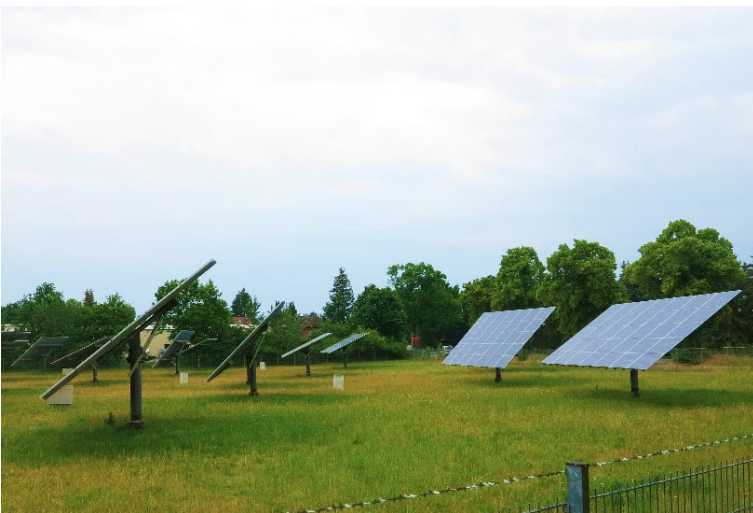
Abbildung 4: zweiachsig nachgeführte PV-Anlage
