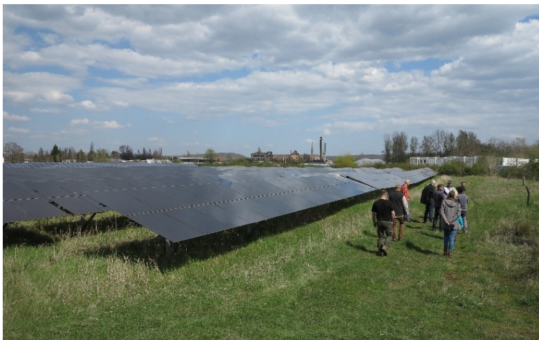
Abbildung 1: PV-Anlage mit starrer Reihenaufstellung in Südausrichtung
