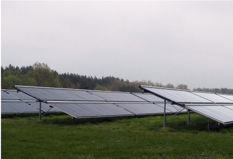
Abbildung 2:Solarthermieanlage für die Fernwärmeversorgung, südausgerichtet, starr verankert
