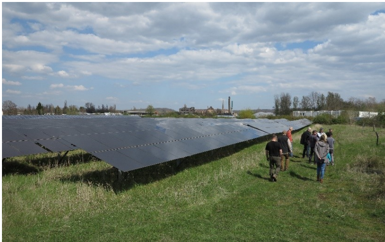
Abbildung 1: PV-Anlage mit starrer Reihenaufstellung in Südausrichtung
