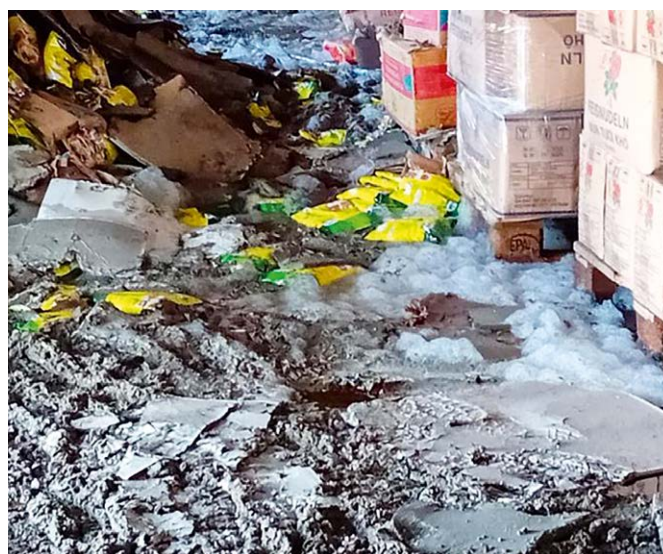
Abbildung 20 und 21: Brand- und Löschwasserschäden im Lagerobjekt (Fotos: LÜVA Landkreis Nordsachsen)
