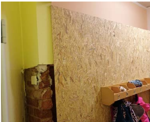
Abbildung 14: Mangelhafte und unsachgemäße Abschottung des Sanierungsbereiches im Zugangsbereich der Kindertagesstätte als Ursache von Raumluftkontaminationen mit Schimmelpilzsporen
