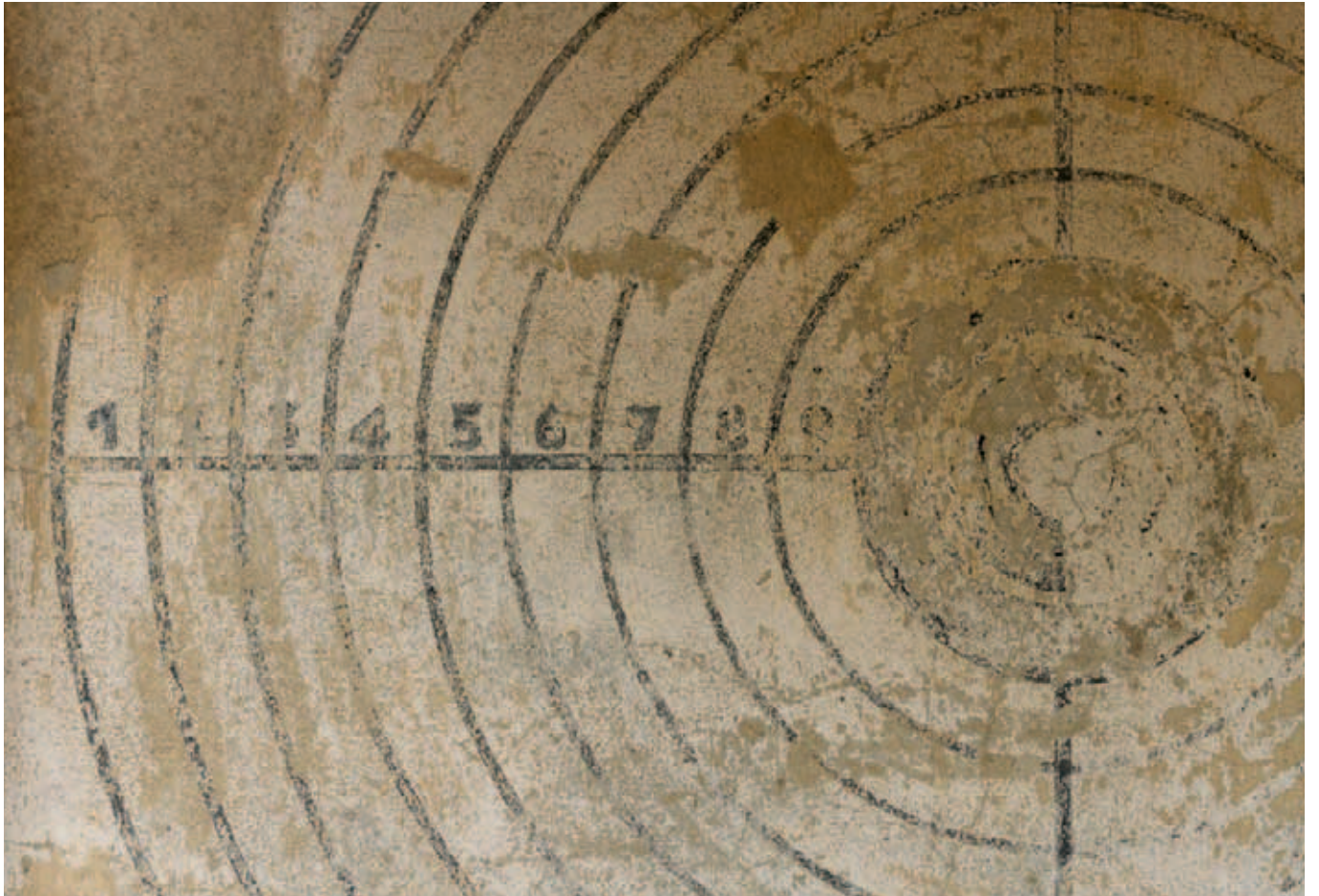
Ausschnitt einer Zielscheibe an der Fassade der ehemaligen Spinnerei
