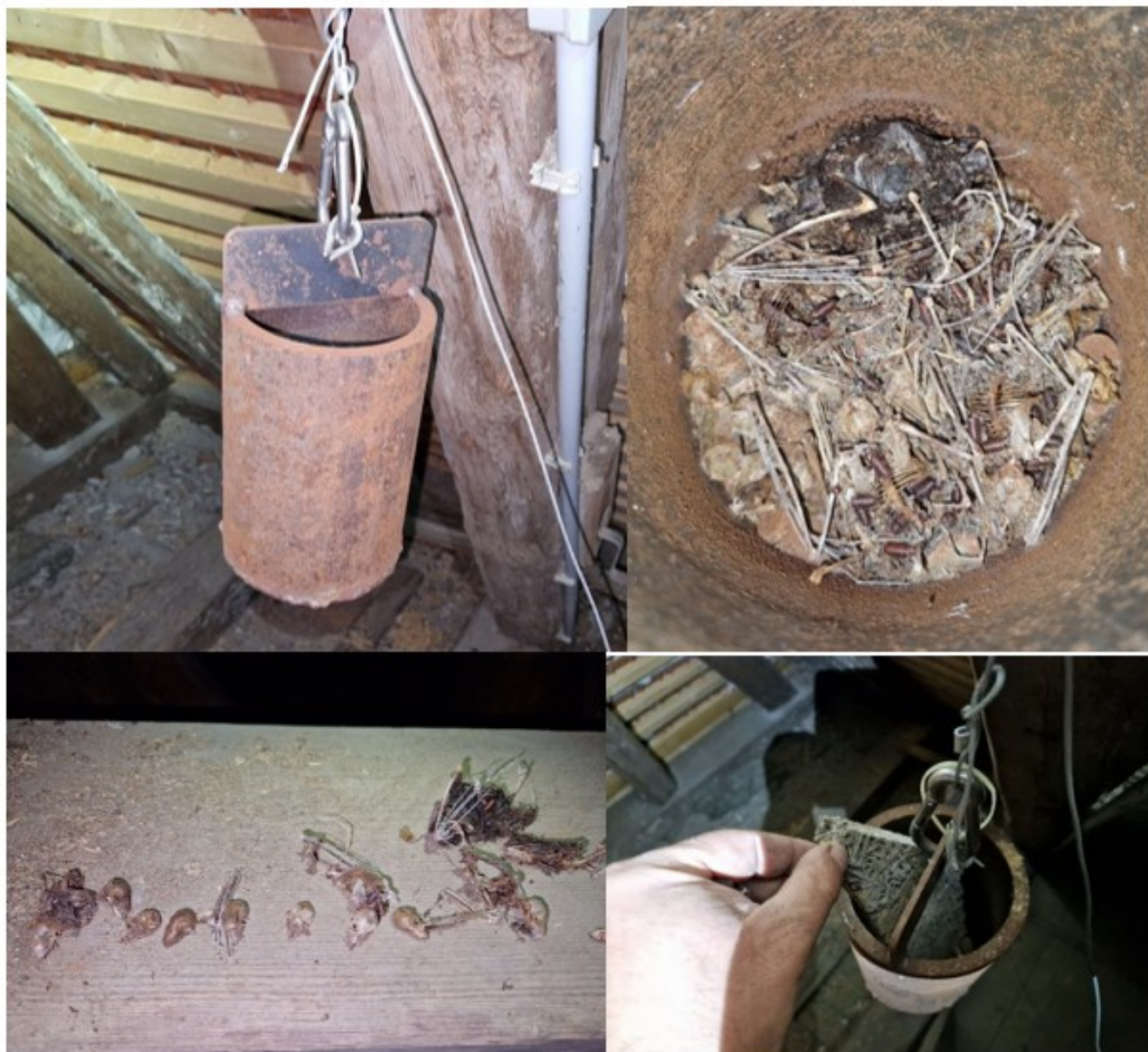
Abbildung 190: Aufgefundene Fallensituation im Gegengewicht einer Dachbodenfalltür.
