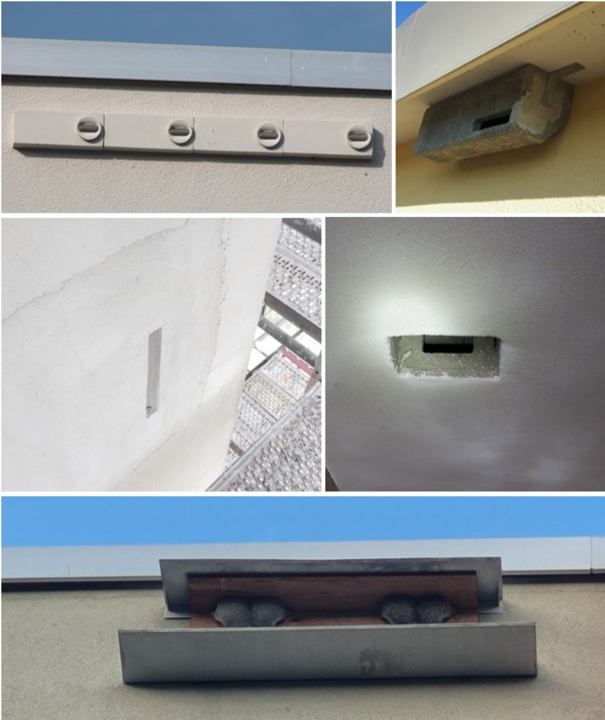
Abbildung 256: Beispiele für offensichtlich fehlerhaft eingebaute Kästen.
