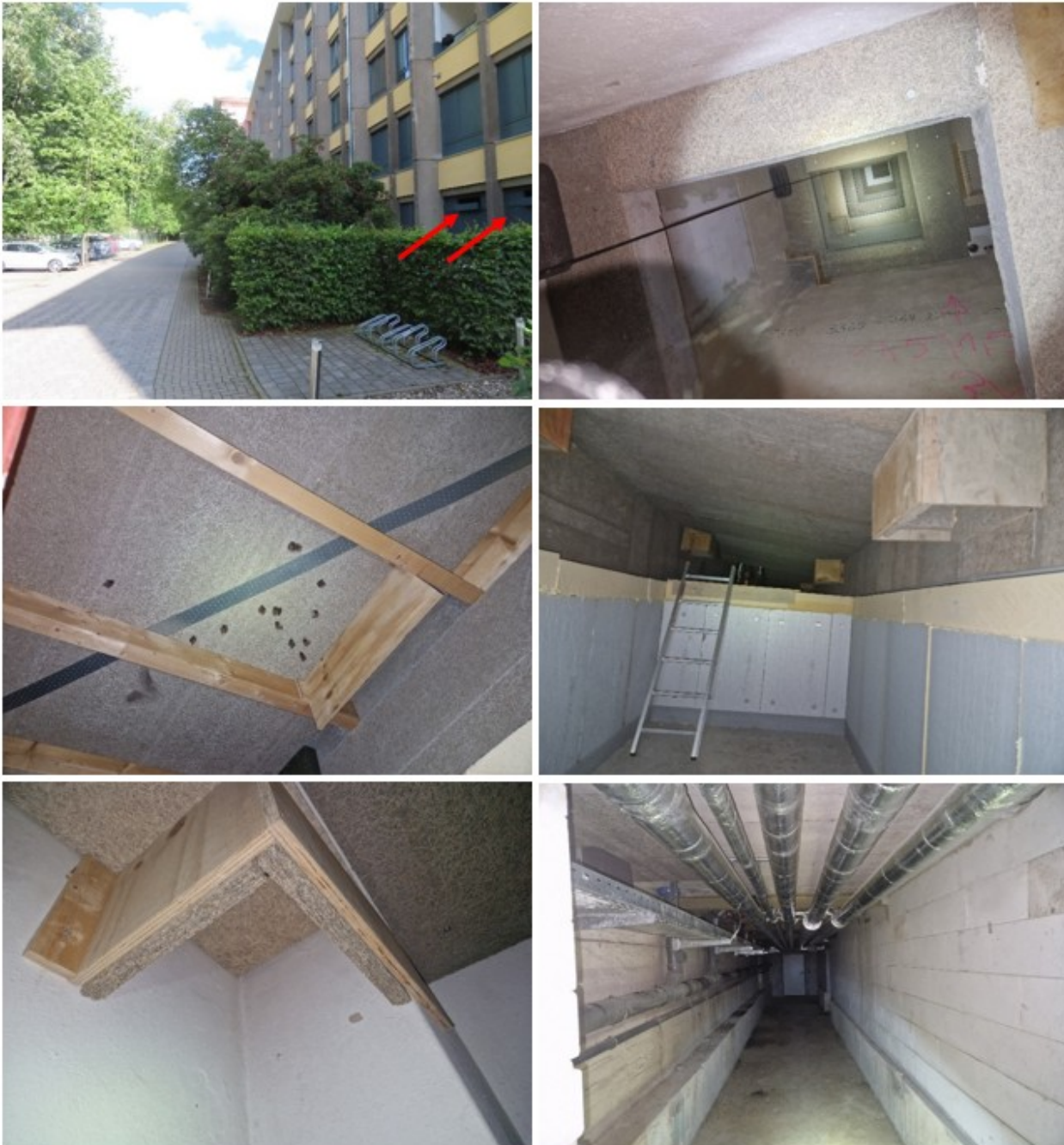
Abbildung 123: Beispiel einer Komplexsanierung mit Erhalt des Wochenstubenquartiers der Kleinen Hufeisennase.
