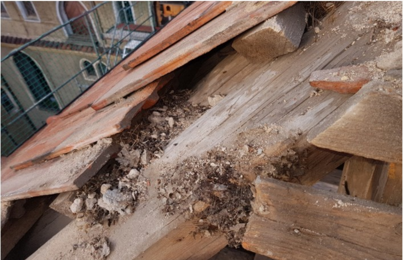
Abbildung 132: Bei der Nutzung von Quartieren im Bereich von Firstziegeln und Gratziegeln sind im Dachbodeninneren nur geringe Kotmengen festzustellen.
