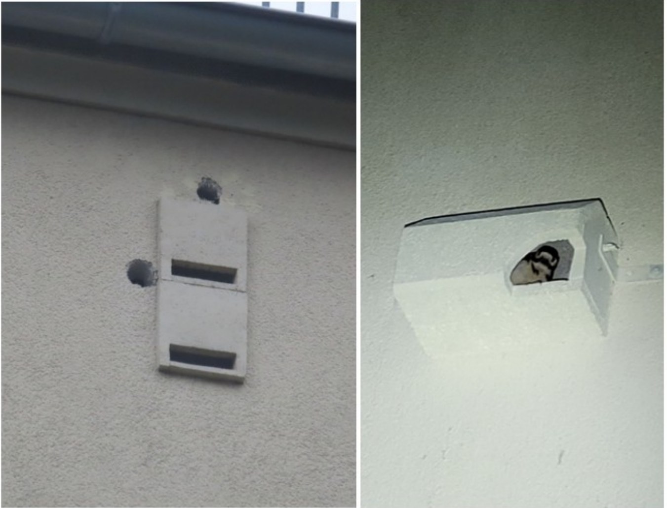
Abbildung 181: Nutzung von Wärmedämmverbundsystemen durch Buntspechte.
