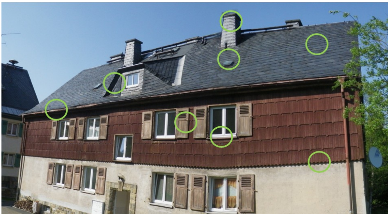
Abbildung 5: Spaltenquartiere von Fledermäusen an Gebäuden können in sehr verschiedenen Strukturen bestehen.
