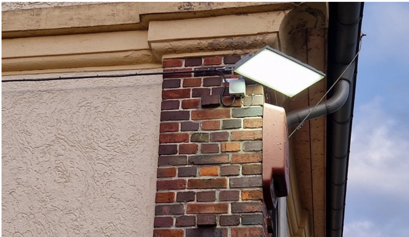
Abbildung 185: Extrembeispiel für die ungünstige Positionierung von Beleuchtungselementen.
