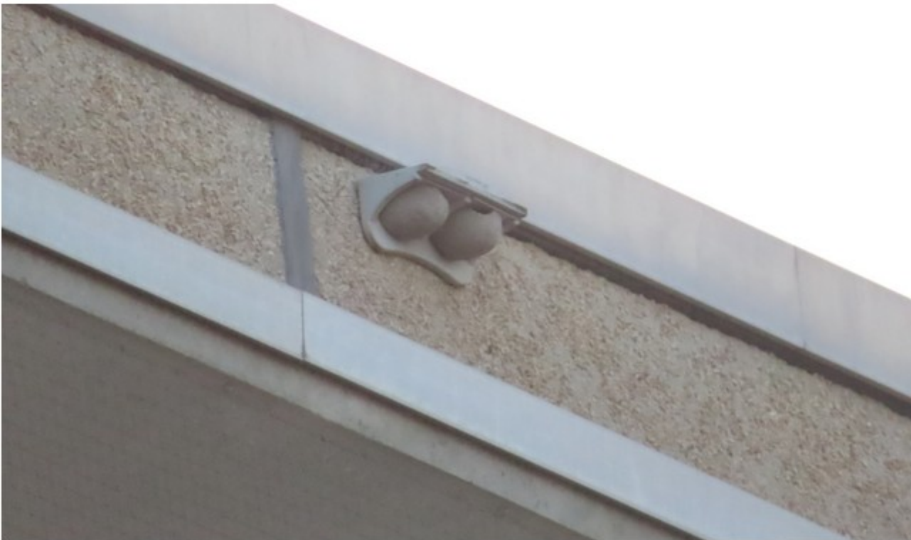
Abbildung 189: Die in den Beispielen dargestellten unmittelbar über Balkonen angebrachten Nisthilfen für Mehlschwalbe, Fledermäuse und Mauersegler sind nicht funktional.
