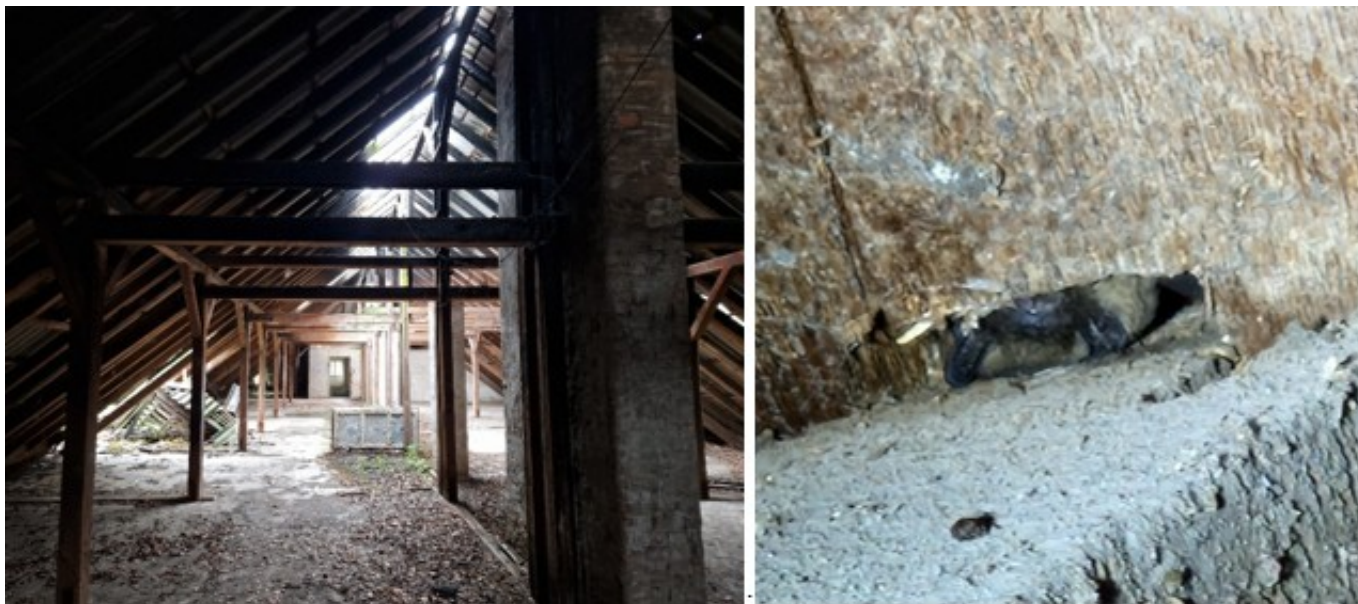
Abbildung 250: Teilweise eingestürzter Dachstuhl mit zahlreichen Quartierstellen von Zwergfledermausarten und Langohrfledermäusen in Zapfenlöchern der noch intakten Bereiche .
