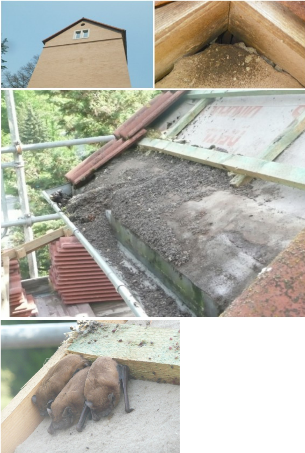
Abbildung 77: Massenwinterquartier des Abendseglers in Spalten zwischen Unterspannbahn und Dachziegeln.
