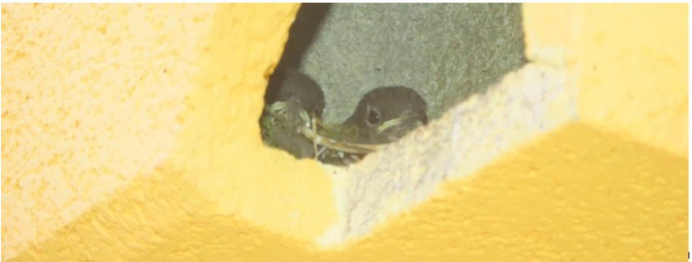
Abbildung 36: Der Hausrotschwanz besiedelt Gebäude auch während der Bauzeit, wodurch Konflikte entstehen können. Das Bild Mitte rechts zeigt ein Nest in einer Mauernische, in dem baubedingt eine Brut zerstört wurde. Der Hausrotschwanz besiedelt oft Nischenbrüterkästen (unten).
