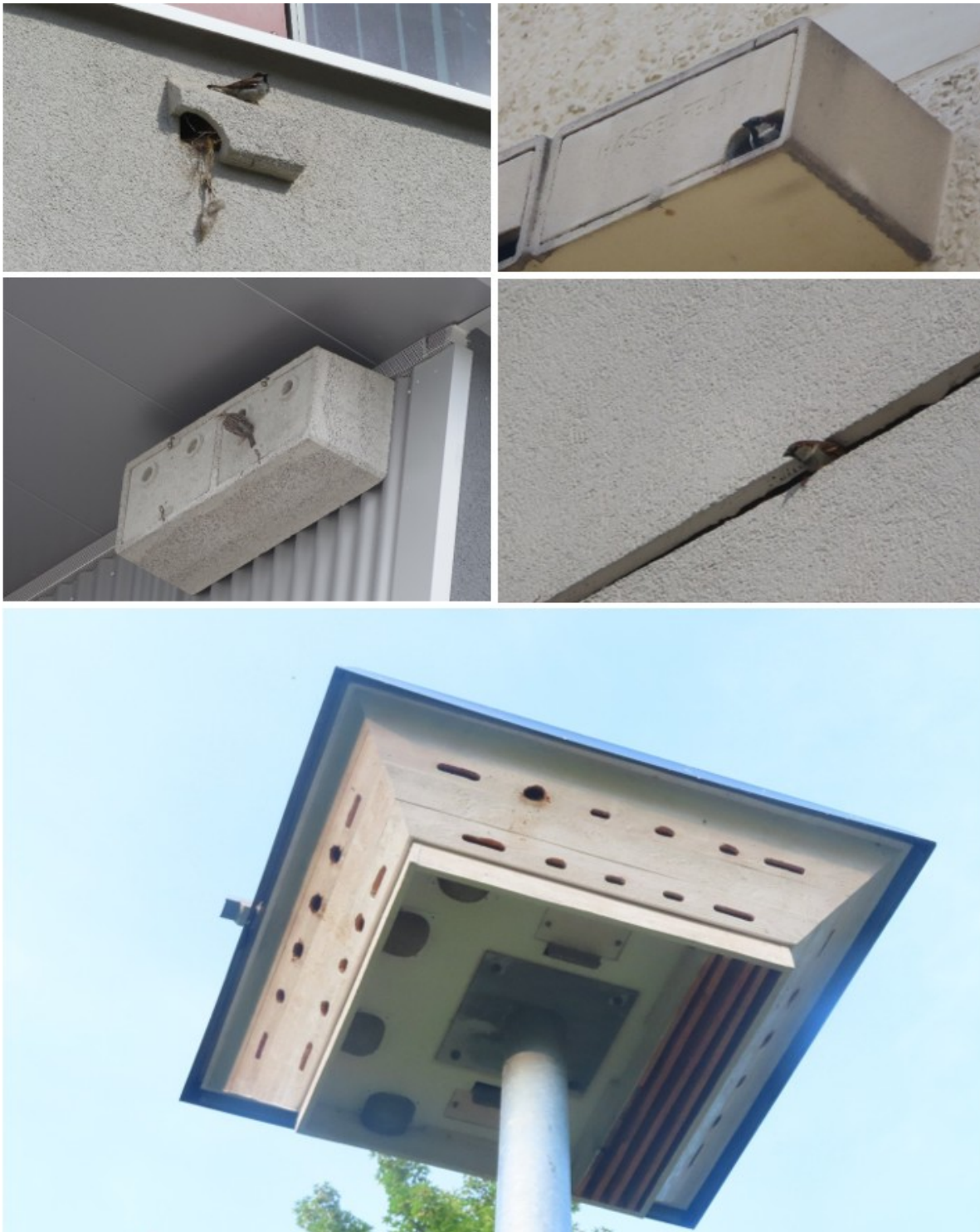
Abbildung 34: Sperlinge nutzen vielfältige Strukturen. An Ständerkonstruktionen ist auf specht-sichere Ausführung zu achten, da Spechte Höhlen öffnen und Brutplätze zerstören können.
