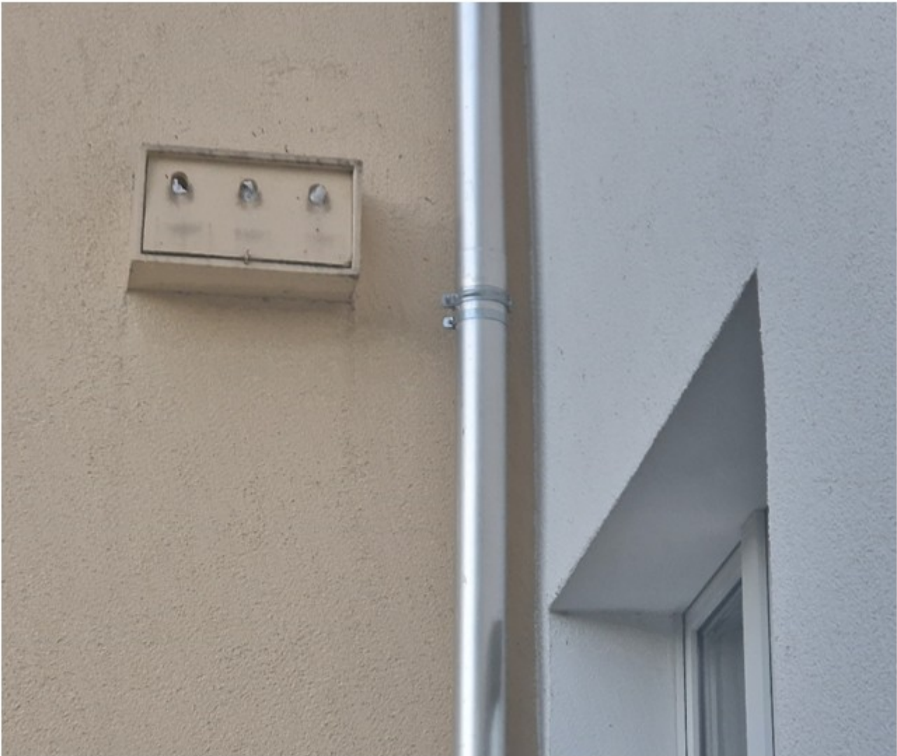
Abbildung 175: Durch Mieter verschlossener Kasten in Fensternähe.
