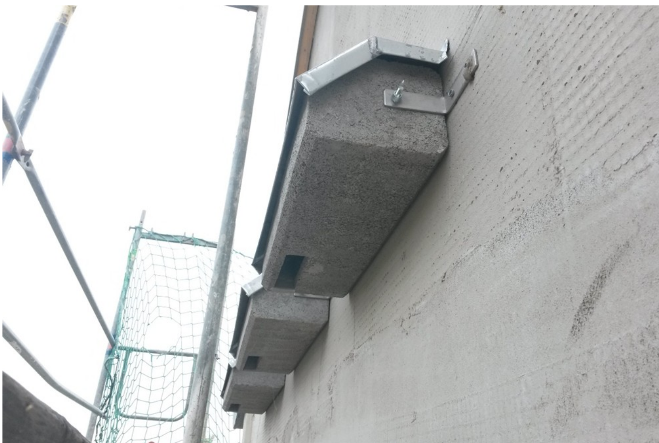
Abbildung 194: Wetterschutzüberdachung von Mauerseglerkästen schützen vor eindringender Feuchtigkeit.
