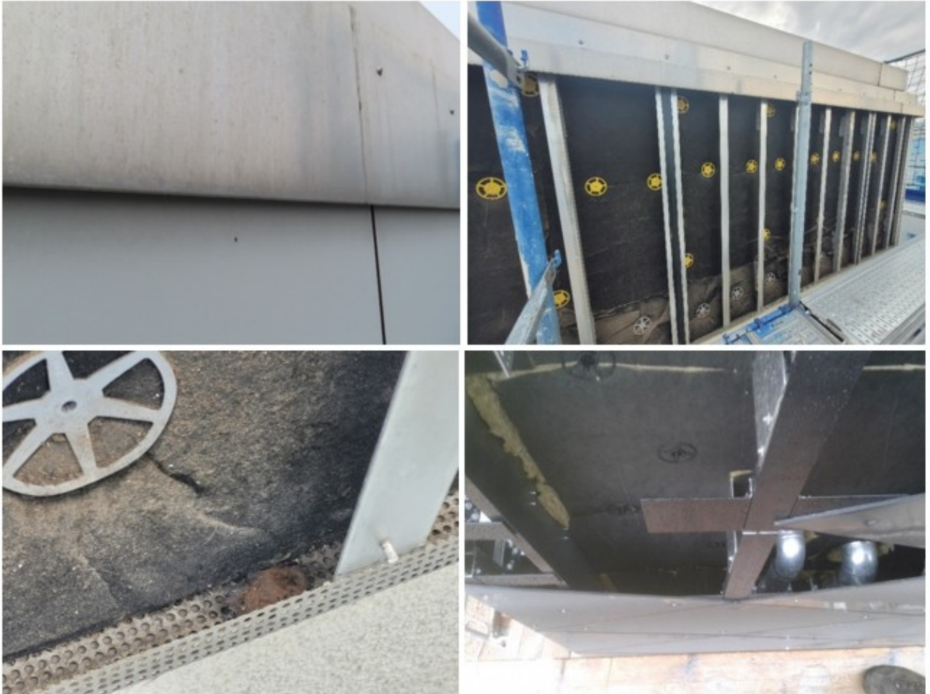
Abbildung 192: Vorhangfassade mit Fallenwirkung.
