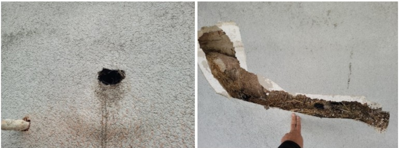
Abbildung 247: Spechtschlag und Gangsystem in Fassadendämmungen.
