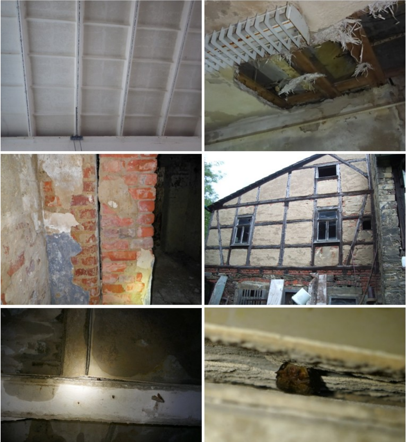
Abbildung 10: In leerstehenden Gebäuden finden sich viele Quartierstrukturen in Spalten und Hohlräumen an der Außenfassade und in den Innenräumen. Die unteren Bilder zeigen den Hangplatz eines Braunen Langohrs hinter einer Putzscholle.
