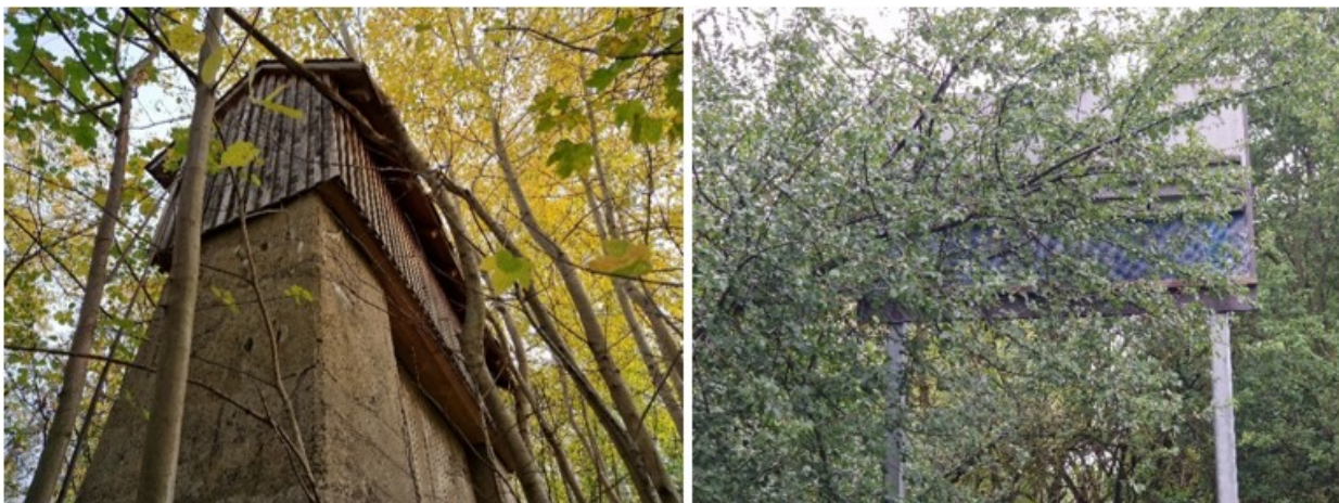
Abbildung 200: Ständerquartiere werden häufig nicht gewartet und deshalb schon nach wenigen Jahren wirkungslos.
