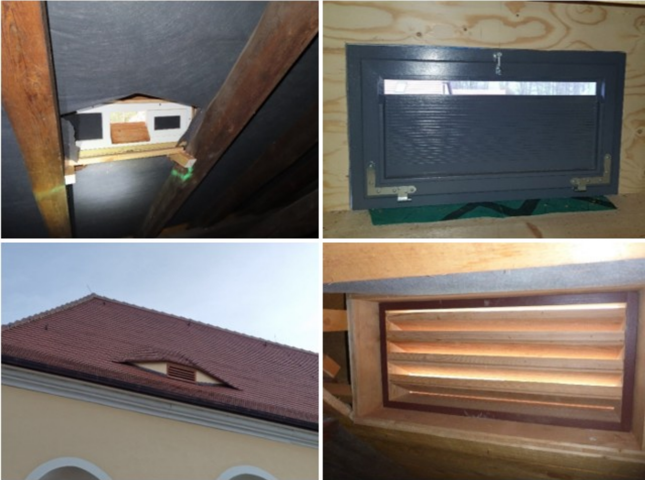
Abbildung 231: Verschiedene Varianten von Gaubeneinflügen. Die unten dargestellten Gaubeneinflüge mit Lamellen zeigen die beste Annahme bei Langohrfledermausarten.
