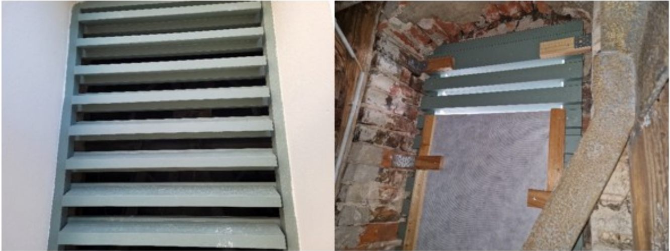
Abbildung 138: Aufkantungen am hinteren Ende der Lamelle vermindern das Einwehen von Schnee oder Feuchtigkeit.
