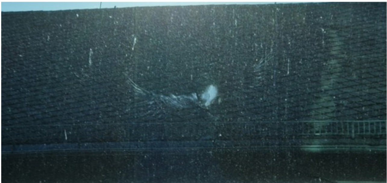
Abbildung 244: Fassaden mit hohem Spiegelungsgrad weisen vor allem in der Nähe von Brutplätzen und Gehölzbereichen hohe Kollisionsgefährdungen auf. Die Federschuppen im unteren Bild zeigen die Spuren einer Vogelkollision.
