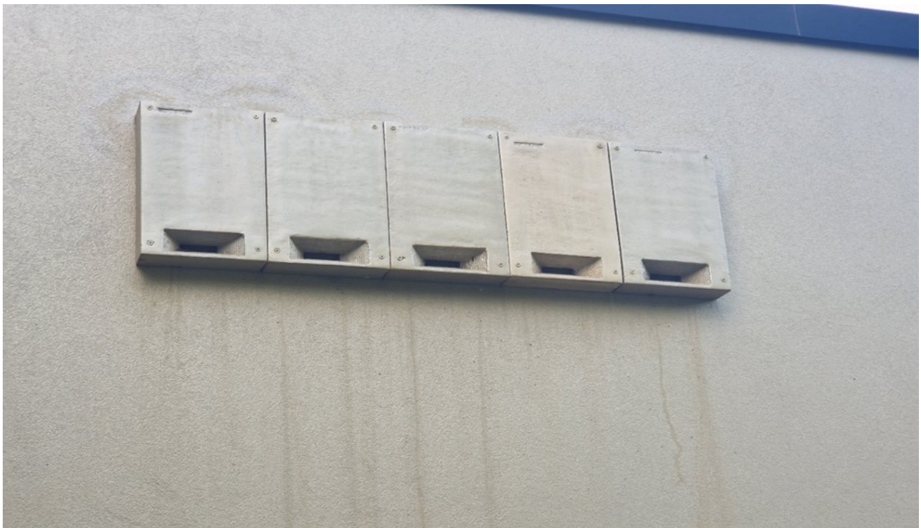
Abbildung 154: Durch Aufputz angebrachte Fledermauskästen, die für die Integration in Wandsysteme vorgesehen sind, können Verunreinigungen an der Fassade auftreten.
