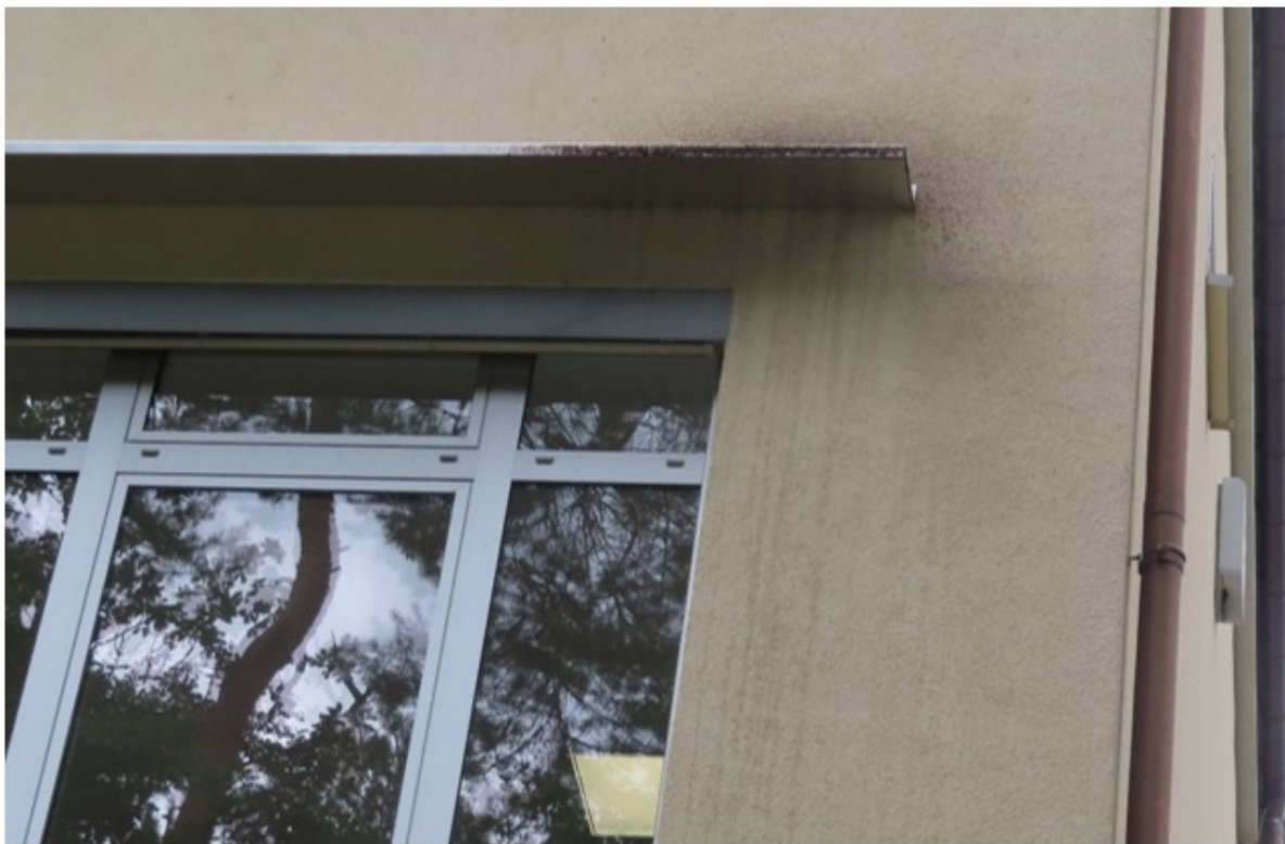
Abbildung 172: Ungeeignete Installation von Kotabweisern.
