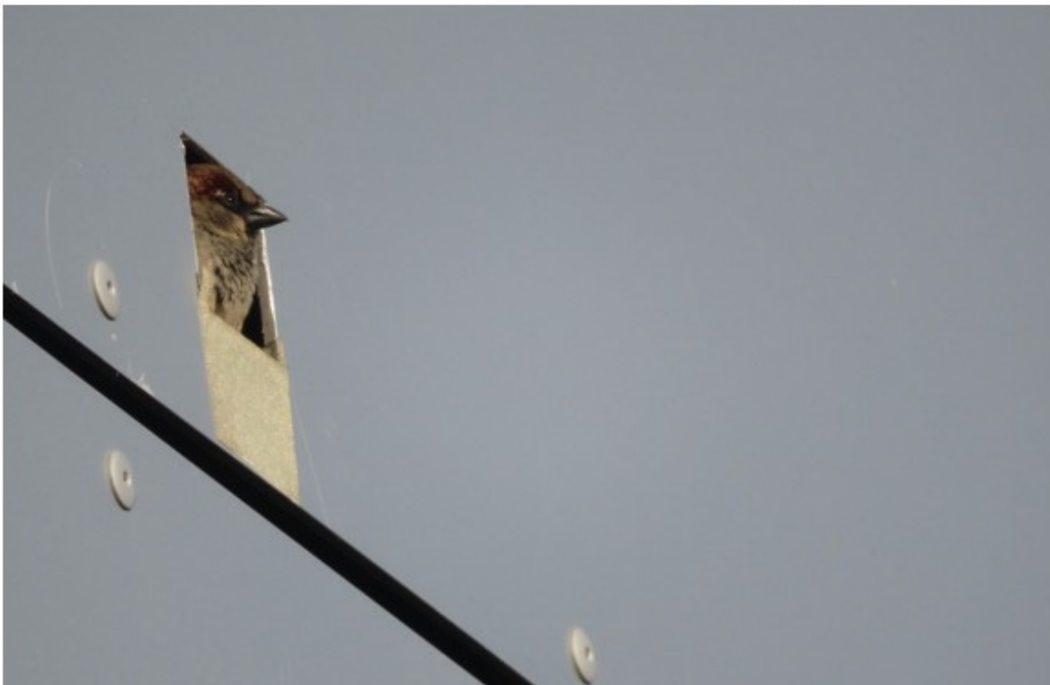
Abbildung 32: In Vorhangfassaden integrierte Brutkästen.
