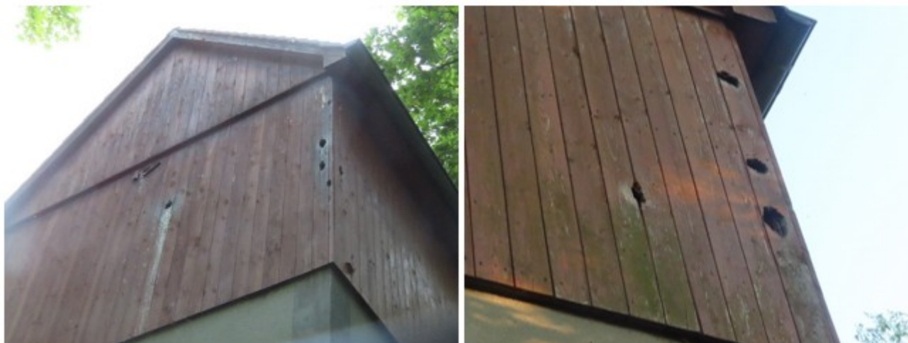
Abbildung 176: Quartier des Abendseglers mit massiven Beschädigungen durch Spechtschläge.
