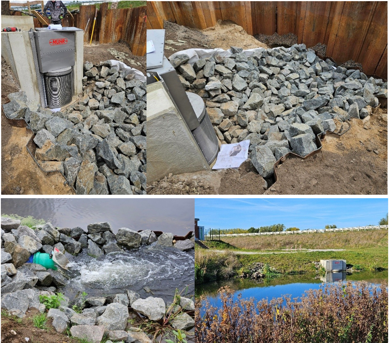
Abbildung A 1: Fotos der Anlage der Stadtwerke Wittenberge: oben: Entnahmebauwerk im Bauzustand vor der Flutung, u. links: Rückleitungsgerinne, u. rechts: Gesamtanlage im Betriebszustand
