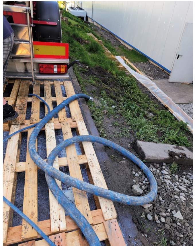
Abbildung 31: Unsachgemäße Ablage eines Schlauches zur Befüllung eines Tankfahrzeugs bei einer Molkerei (Foto: IKL)
