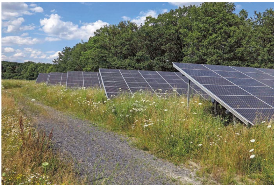
Abb. 3: Photovoltaikanlage mit Schotterweg und mesophilen Grünland, Foto: Archiv Naturschutz LfULG, A. Seidel
