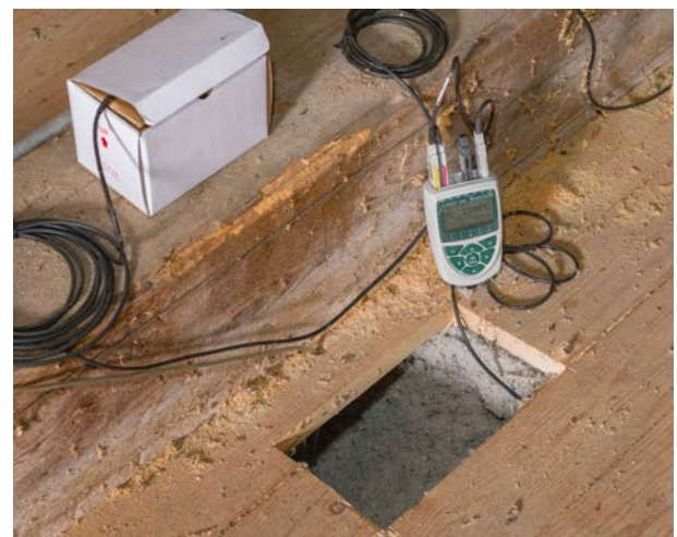
Löbnitz, Kirche, Zelluloseeinblasdämmung und Messgeräte mit laufender Klimaerfassung
