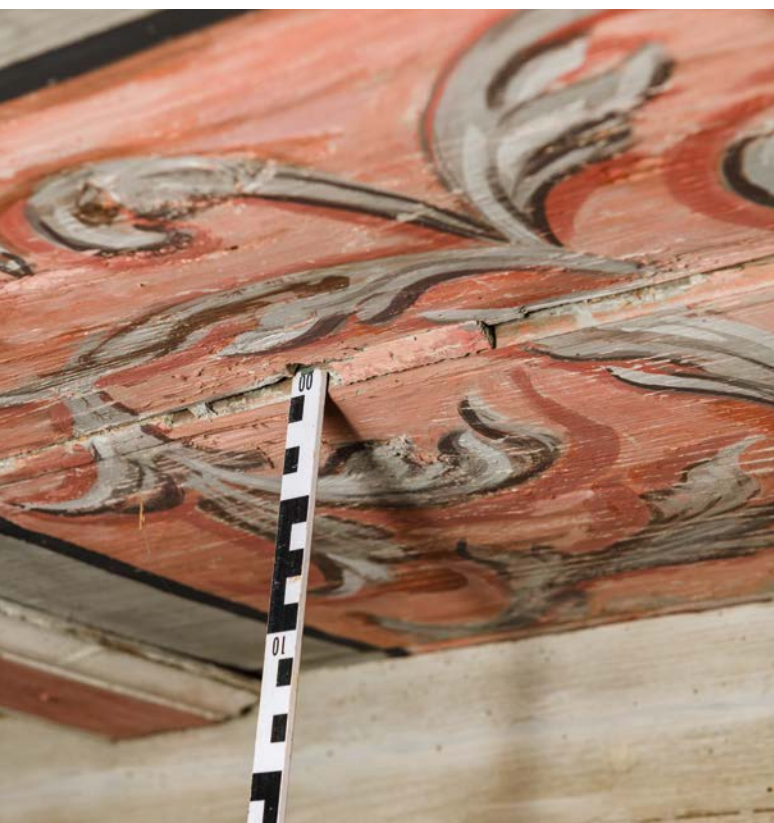
Oybin, Bergkirche, Fuge mit bereits wieder gelöster Ergänzung
