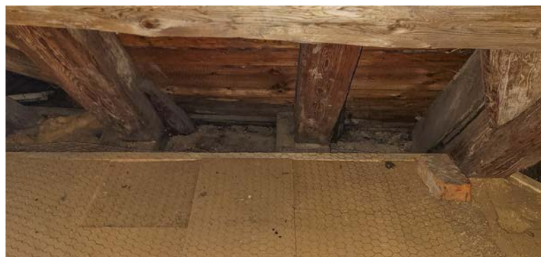
Fehlende Trauföffnung Nordseite
