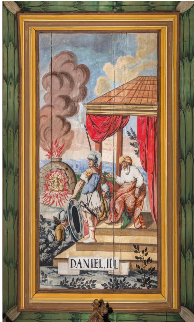
Bildfeld mit offenen Fugen bzw. Rissen
