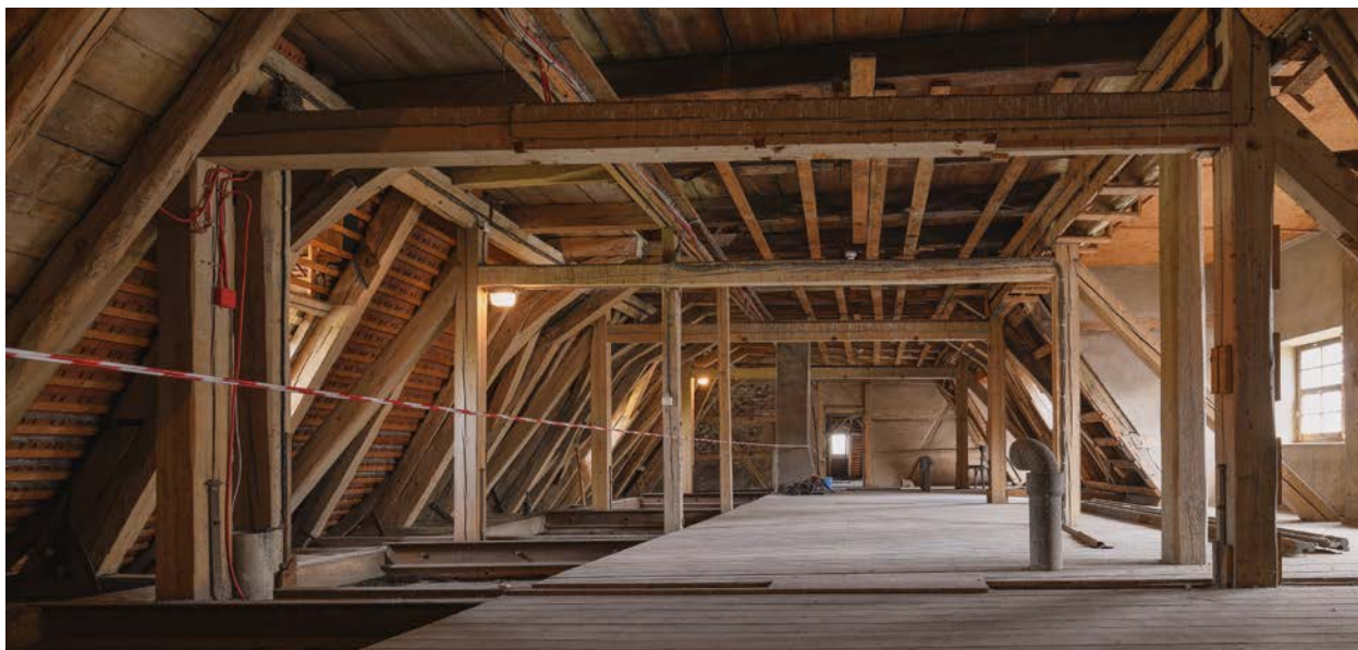
Glauchau, Schloss Hinterglauchau, Dachboden, bereichsweise gediebt
