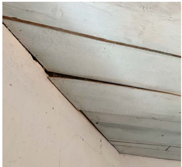
Brettverformung und Fugenbildung
