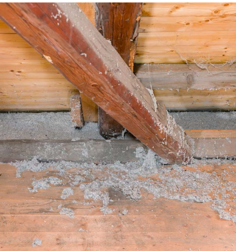
Kirche, Einblasdämmung ohne eingebautes Stellbrett verschließt die Traufe
