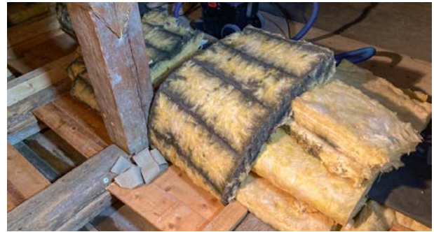
Dresden, Leubnitz-Neuostra, Kirche, Mineralwollendämmung, direkt auf der Deckenoberseite verlegt mit Verschmutzung entlang der Fugen der Deckenbretter
