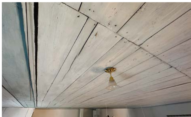
Rissbildung in den genagelten Deckenbrettern
