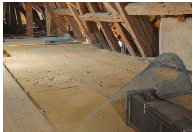
Milkau, Kirche, Holzfaserdämmung mit aufgelegtem Maschendraht als Schutz vor Tierzugang – mit Neuschäden unter hochgerollten Abschnitten
