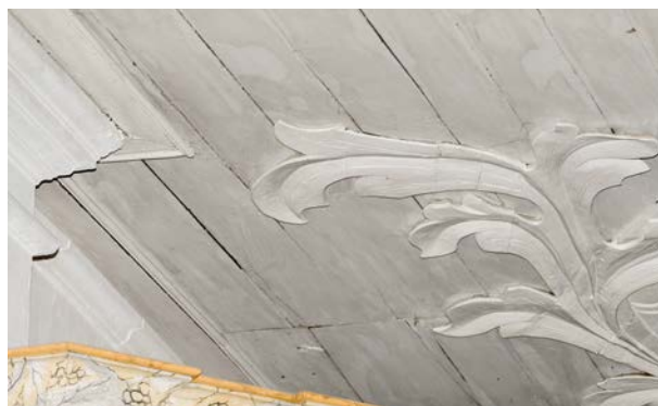
Vereinzelte Rissbildung und Verformung der Deckenbretter
