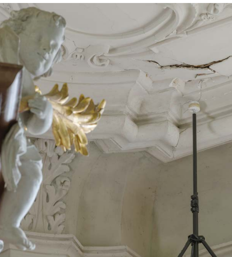
Tiefenau, Schlosskapelle, Riss im Deckenputz
