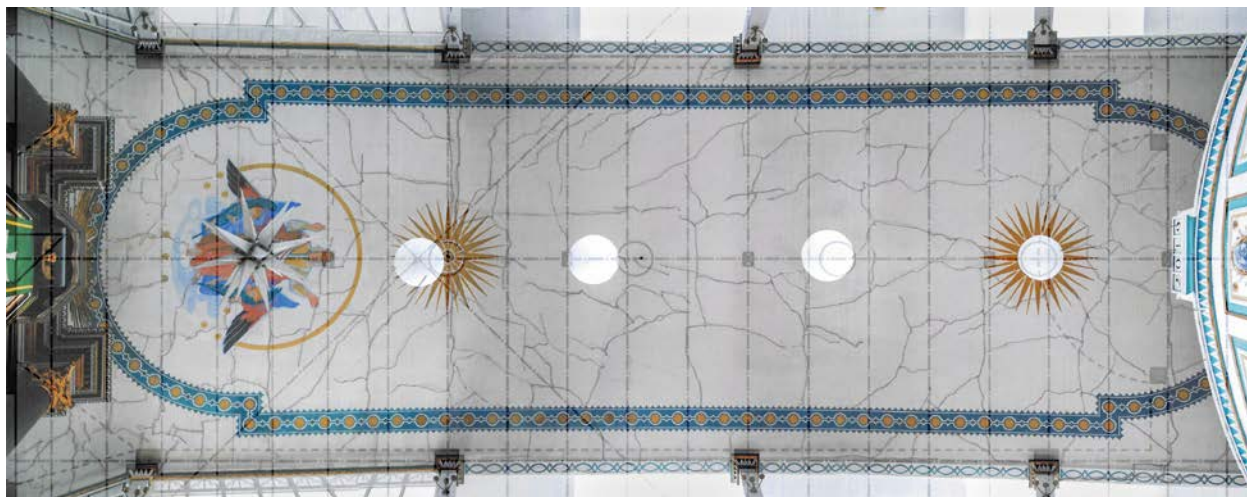
Bockendorf, Kirche, Rissnetz im Deckenputz, Zustand vor der Restaurierung
