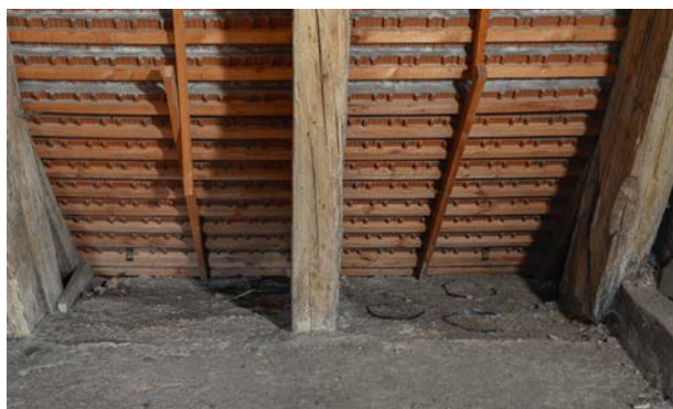
Fehlende Trauflüftung, vermörtelte Ziegeldeckung auf Lattung
