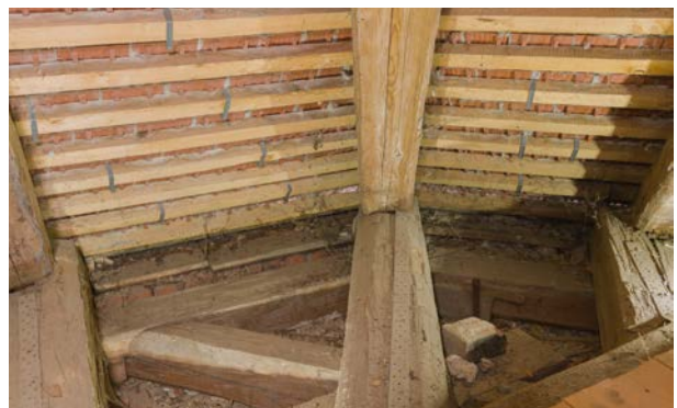
Fehlende Trauflüftung, vermörtelte Ziegeldeckung
