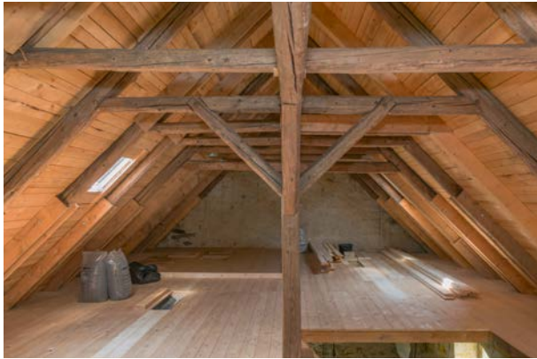
Gedielter Dachboden, Schalung, keine Trauflüftung
