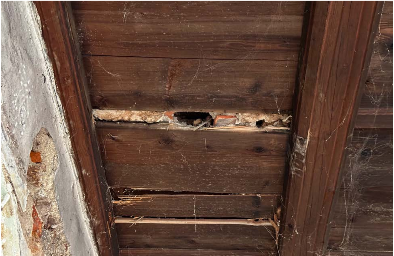
Einschubbretter gerissen und verformt, Schüttung Deckenoberseite
