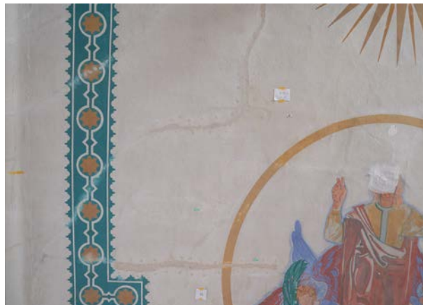
Bockendorf, Kirche, Zustand des Deckenputzes nach Verschluss von Risskanälen und Rovinglöchern
