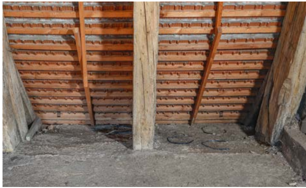
Schloss, Dach mit verschlossener Traufe, vermörtelte Ziegeldeckung
