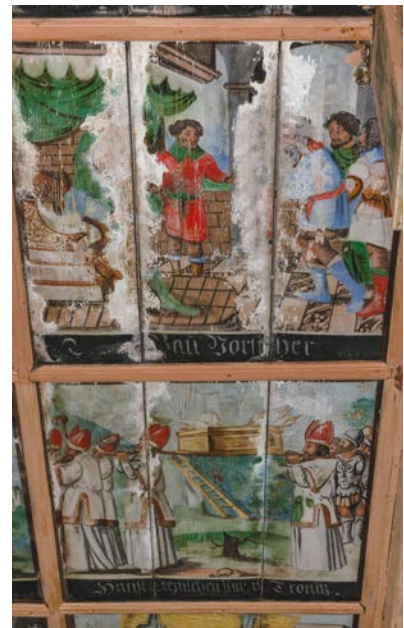
Kiebitz, Kirche, Deckenfeld mit offenen Fugen, Verformungen und Malschichtverlusten
