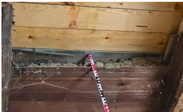
Lehmschlag an angrenzender baugleicher Decke
