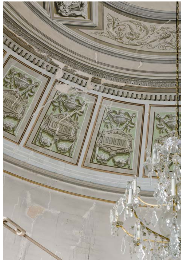
Colditz, Schloss, Risse mit Kittmassen im Deckenputz
