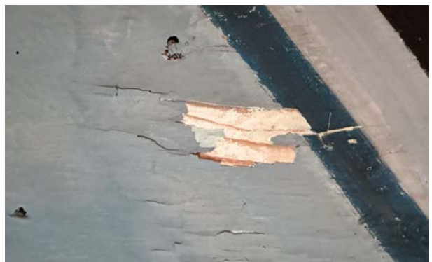
Fassungslockerungen und -ablösungen
